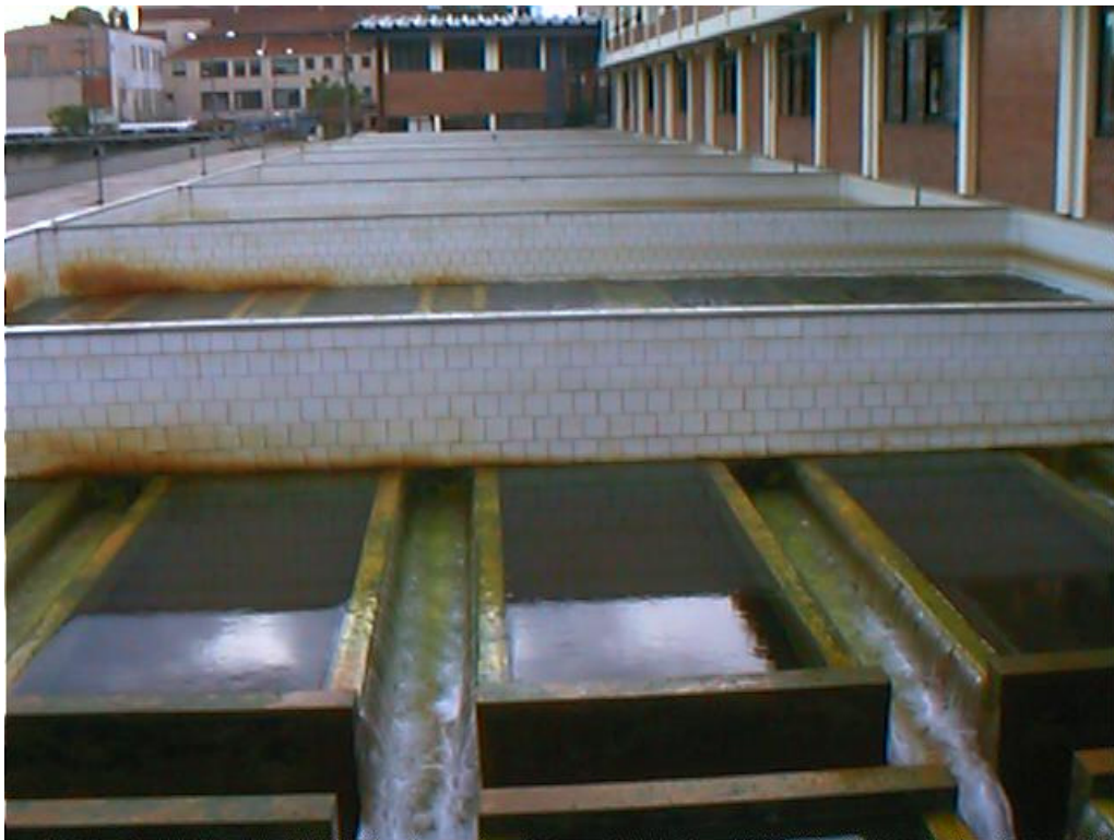
Figura 15: filtros em processo de esvaziamento na ETA Menino Deus, Porto Alegre/RS
