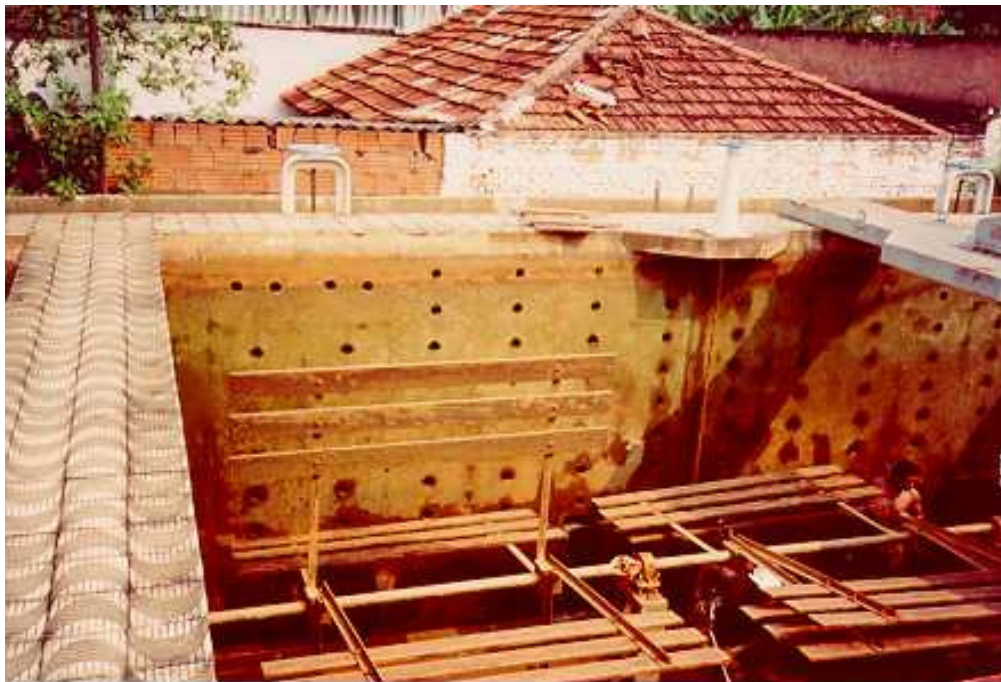
Figura 12: cortina de distribuição de um decantador retangular
