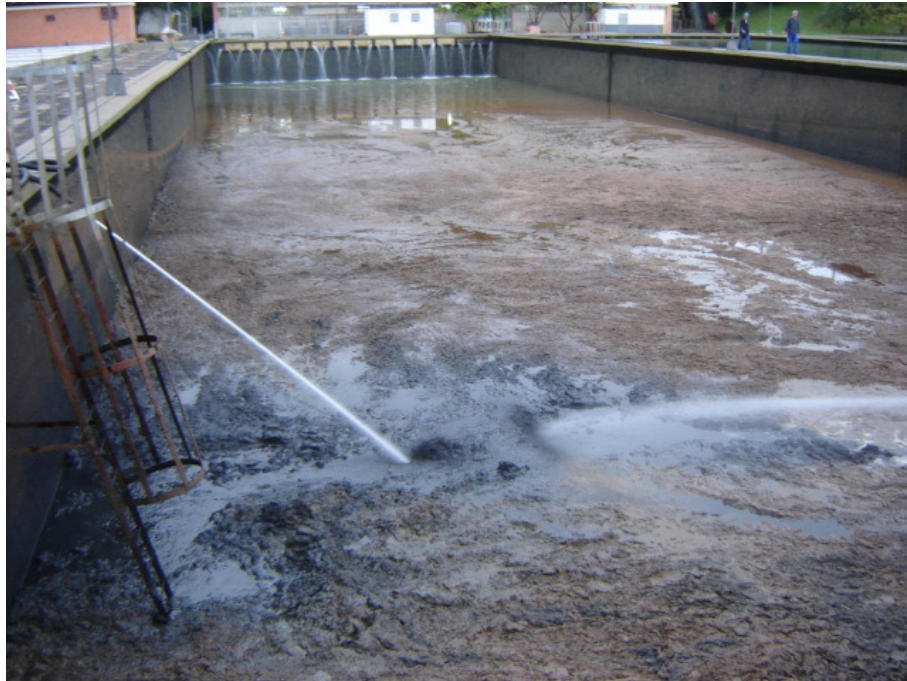
Figura 11: unidade de decantação da ETA José Loureiro da Silva. Porto Alegre/RS, em processo de lavagem.
