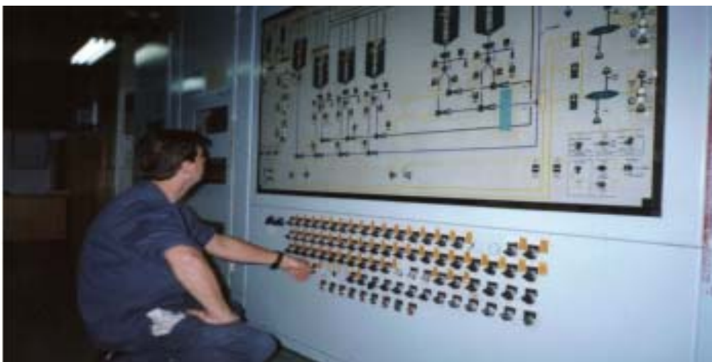
Figura 1: Sala de Controle do Tipo Sinótico
