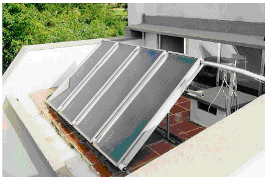
Figura 4.2 – Fotografia do SSAA operando por termosifão na bancada de testes
