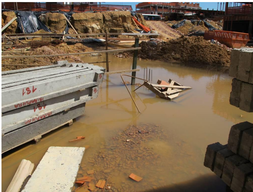
Figura 21 – Falta de drenagem
