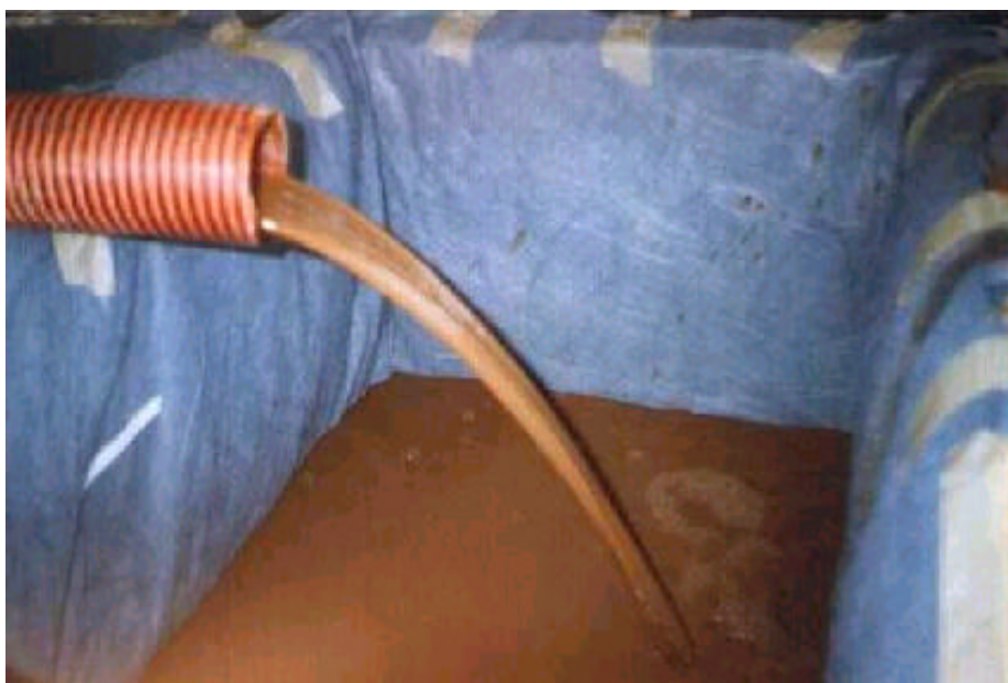
Figura 5.1: Lodo da ETA São João sendo descarregado nos leitos.
