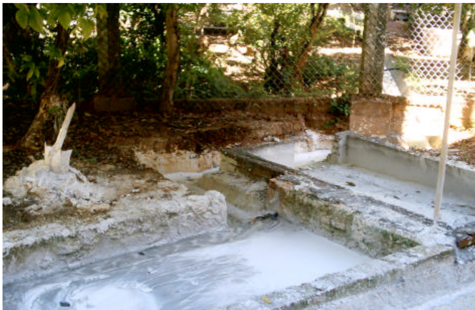
Figura 4.10: Leitos de secagem de resíduo do sistema de alcalinização
