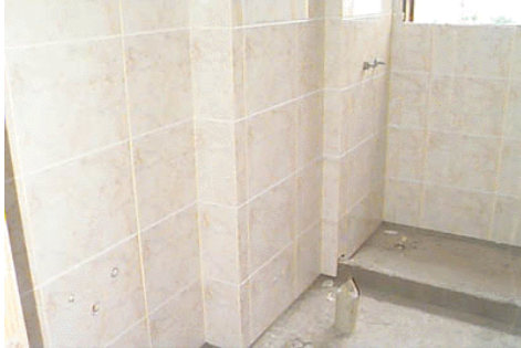
Figura 5.28 – dentes nas paredes gerando necessidade de corte das peças
