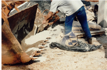
Figura 5.10 - Sacos de cimento rasgados na pá carregadora
