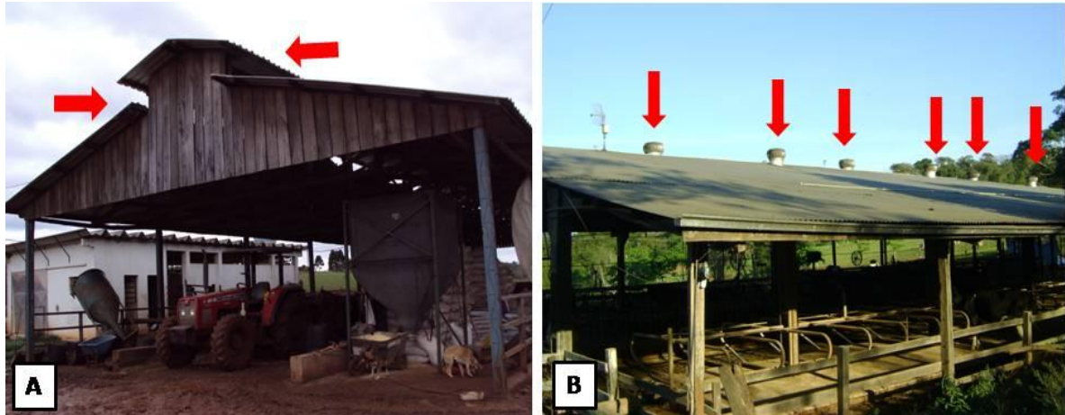
A: lanternim na cumeeira do galpão para permitir maior circulação do ar no interior. B: instalação de exaustores em galpão sem lanternim.
