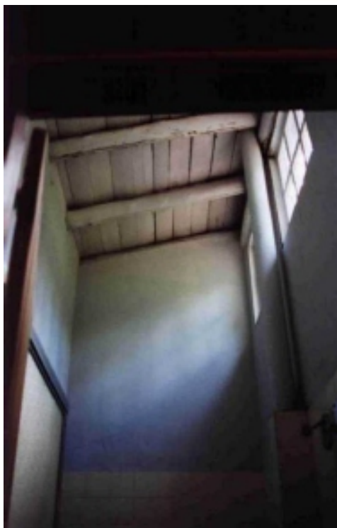
FIGURA 112 - Iluminação e ventilação dos banheiros;
