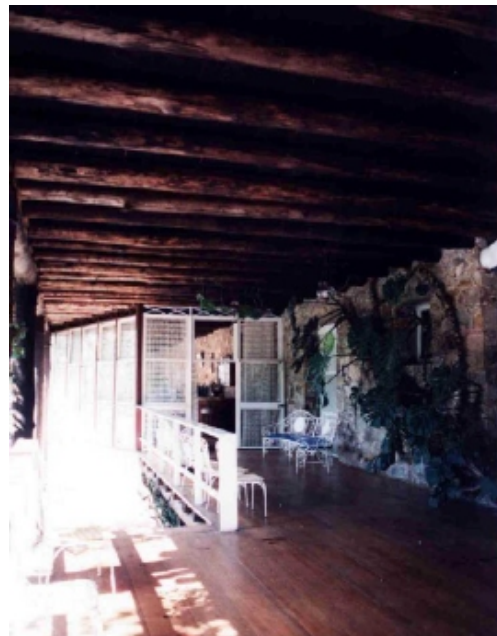
FIGURA 95 - O outro lado do pilotis, ocupado pela salade estar e jantar e fechamento "livre", versão, com montantes em madeira dos panos de vidro. Visível, nesta foto a concepção estrutural; assemelhada às nervuras das estruturas de concreto.
