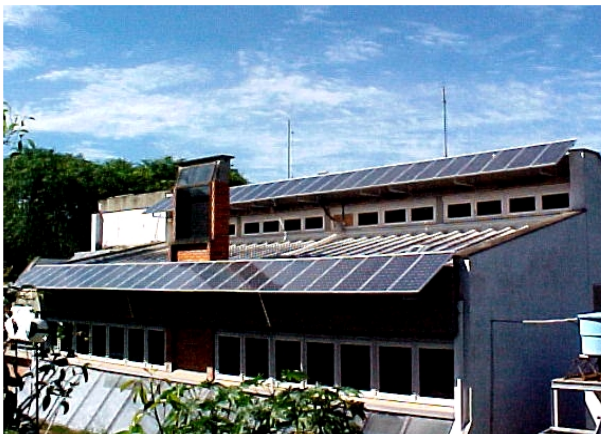
Figura 3.1 Prédio do Laboratório de Energia Solar da UFRGS com os módulos instalados.
