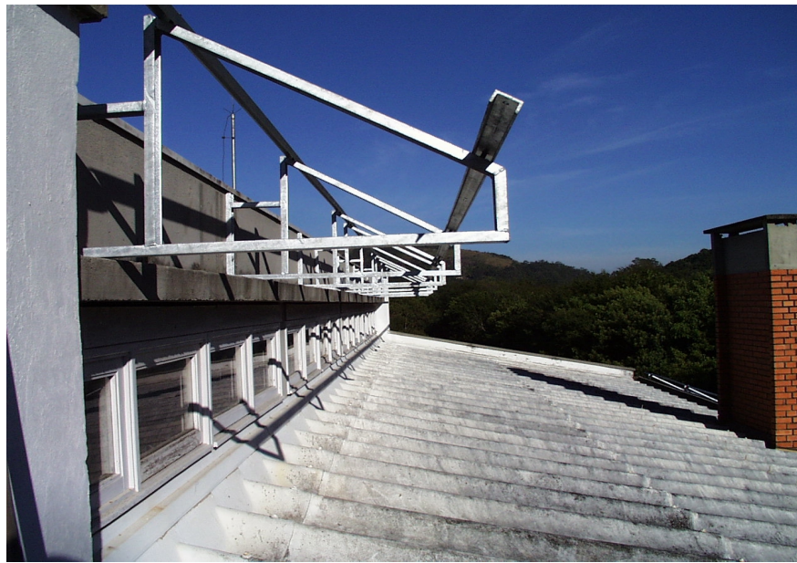
Figura 4.7 Estrutura da instalação dos módulos na parte superior do Laboratório de Energia Solar.
