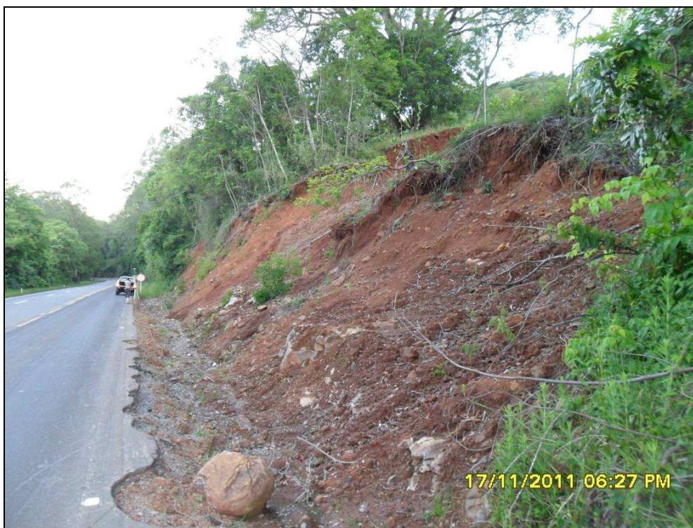
Figura 30 – Deslizamento de terra em borda de rodovia, entre os municípios de Gramado e Três Coroas.
