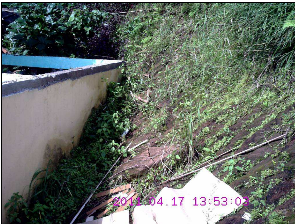
Figura 25 – Parte lateral de casa de alvenaria destruída por movimento de massa, e substrato rochoso, onde foi realizado um corte para construção da residência no município de Três Coroas - RS.
