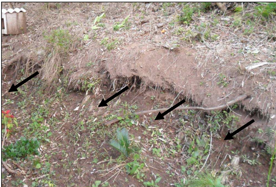
Figura 3 - Ocorrência de Piping , município de Parobé - RS.
