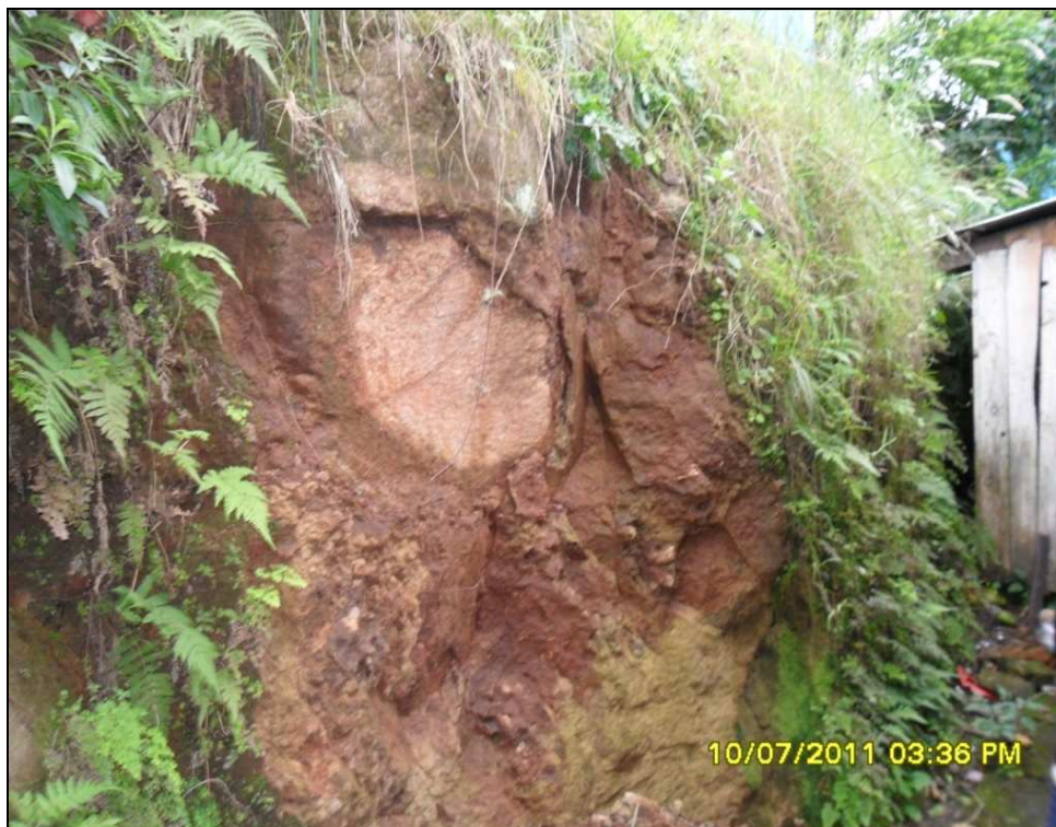
Figura 10 - Movimento de massa com risco de queda de blocos sobre residências, município de Parobé - RS.
