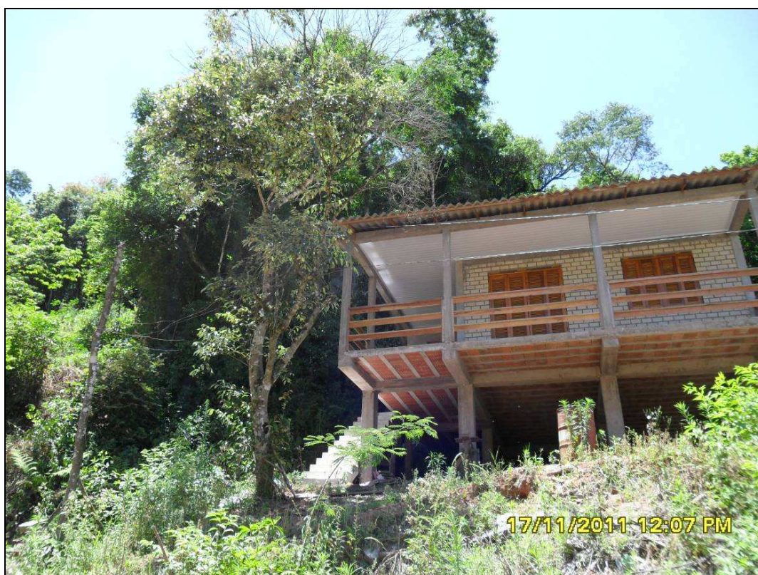
Figura 28 – Casa de médio padrão sendo construída em área de perigo no município de Igrejinha - RS.
