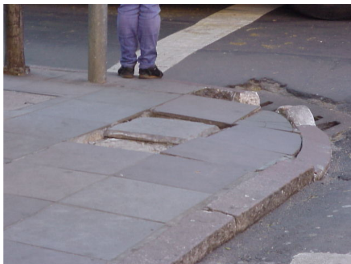
Figura 10. O péssimo estado de algumas calçadas colocam a PPD em risco.
