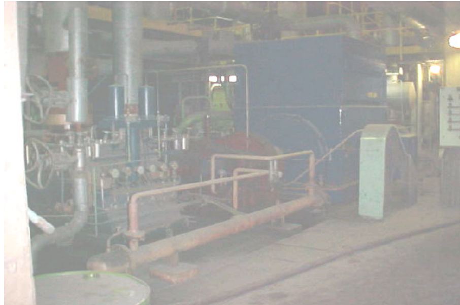
Figura 3.7 Bomba de Alimentação da Caldeira de Candiota II, Fase B.
