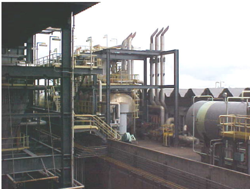
Figura 3.6 Tanque de Alimentação/desaerador de Candiota II, Fase B.
