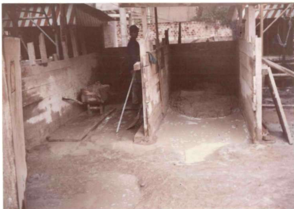
Figura 3.3.4-a - Argamassa básica armazenada sem proteção.
