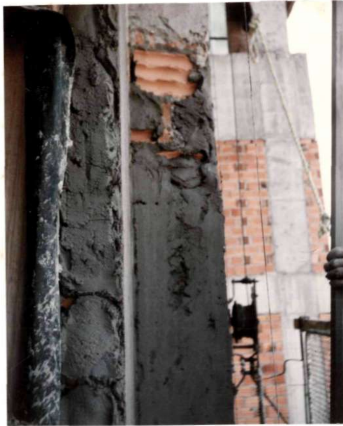
Figura 3.3.10-b - Detalhe de uma fachada em que foi necessário quebrar o tijolo para evitar a ocorrência de grandes espessuras no revestimento.
