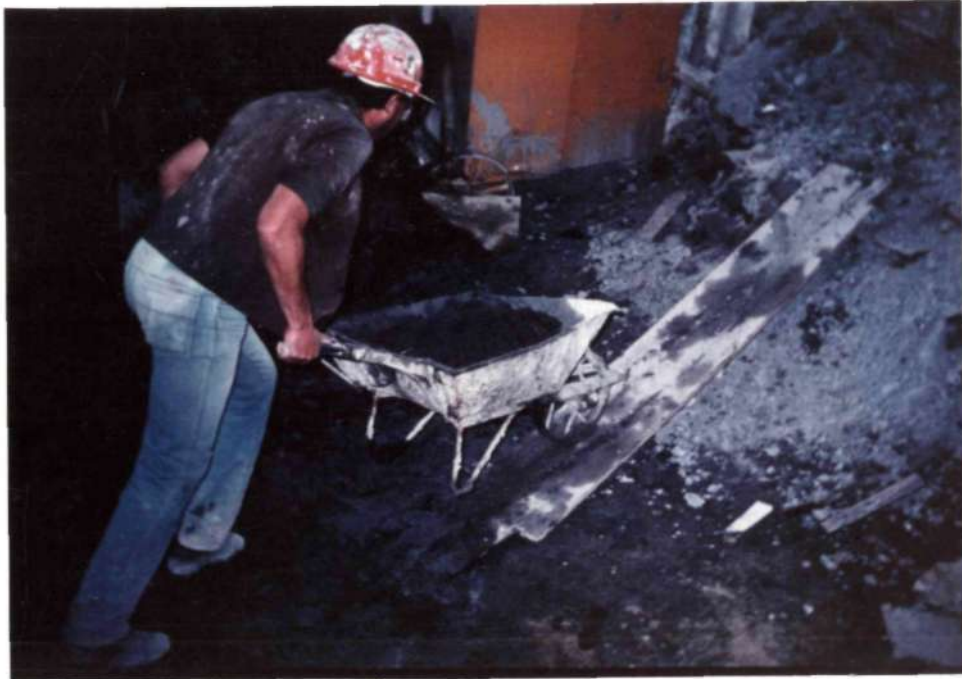
Figura 3.3.8-b - Caminho interno de um canteiro de obra com aclave e entulhos.
