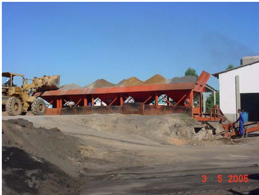
Figura 42: Vista panorâmica dos silos carregados com agregados
