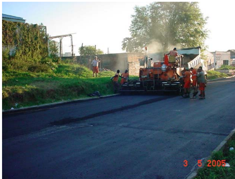
Figura 53: Execução do trecho com concreto asfáltico com incorporação de borracha de pneus.
