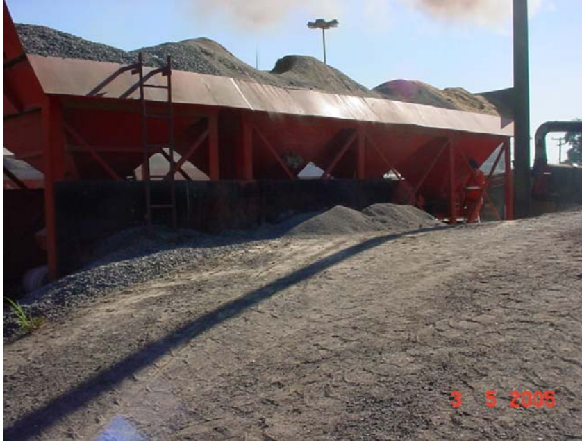
Figura 46: Vista panorâmica dos silos carregados com agregados
