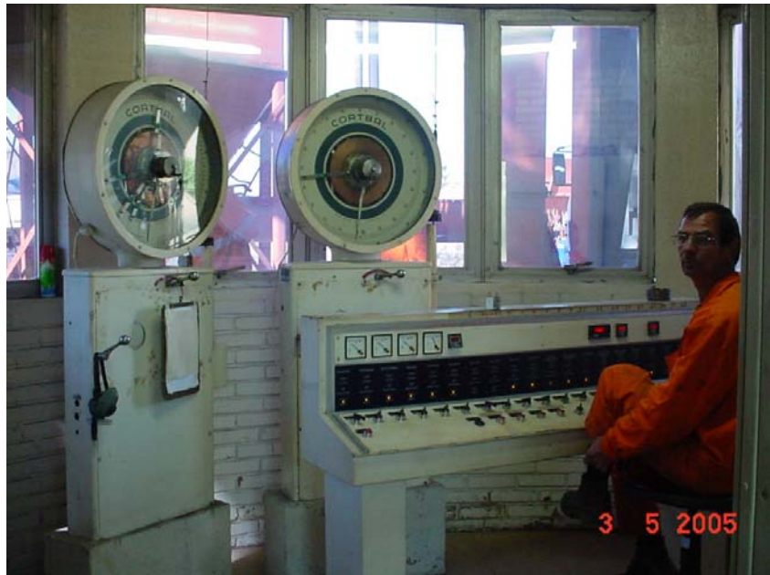
Figura 41: Vista do controle da usina gravimétrica
