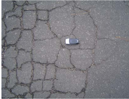
Figura 2: Exemplo de trincas por fadiga em uma rua de Porto Alegre
