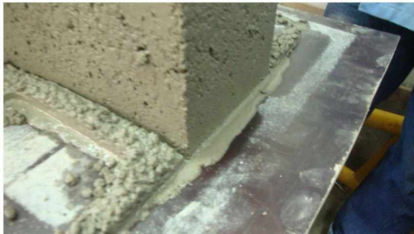
Figura 22 – Formação de nata de cimento ao redor do bloco
