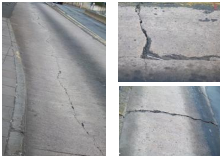
Figura 2 – Manifestações patológicas em trecho pavimentado com concreto na avenida Protásio Alves, Porto Alegre
