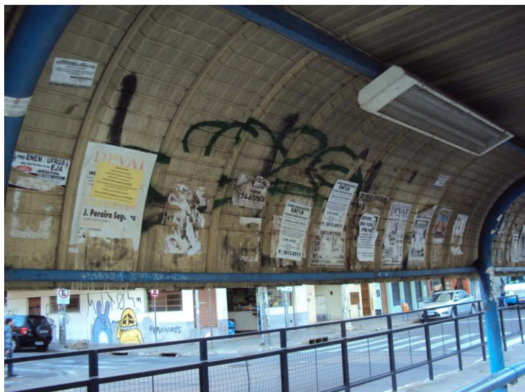
Figura 5 – Estado de limpeza de uma das coberturas de uma estação
