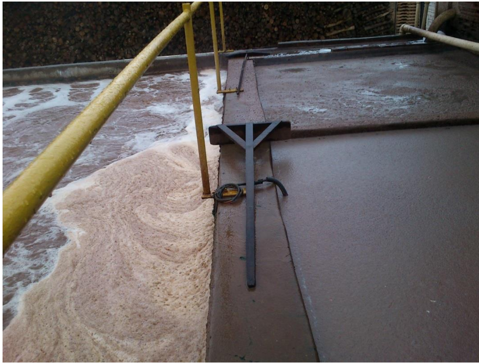
Figura 3.1: Decantador do tratamento primário.
