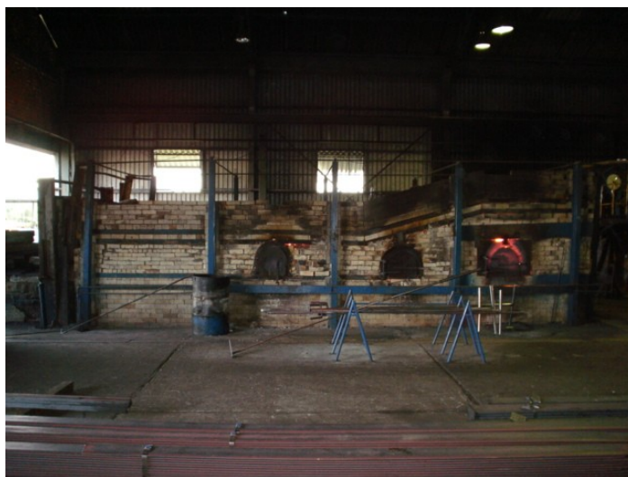
Figura 3.1 – Perfil lateral do forno de aquecimento de barras.
