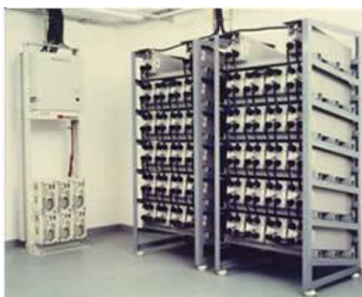
Figura 11: Banco de baterias de chumbo-ácido do tipo VRLA.
