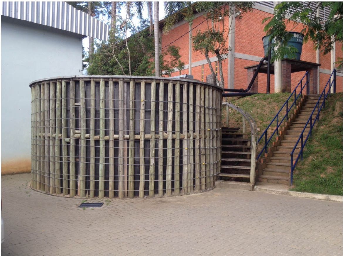
Figura 18 – Tanque de mistura visto de fora
