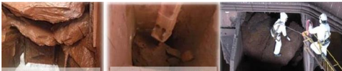
Figura 54 – Intervenções nas plantas de britagem devido ao modo de falha “travamento de britadores por blocos (Matacão)”.
