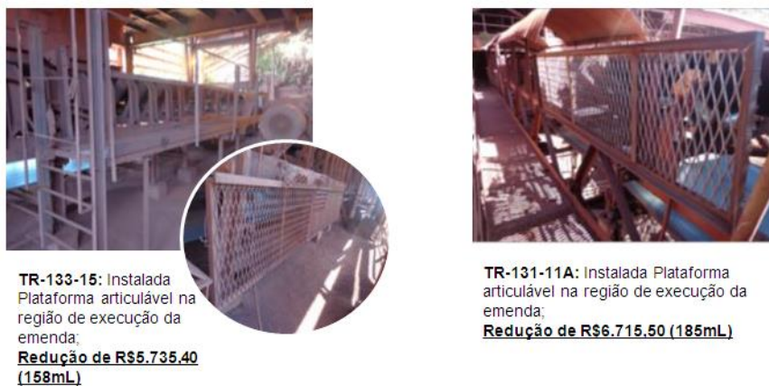
Figura 60 – Exemplos de plataformas instaladas com indicação da redução de custos no serviço de montagem de andaimes.
