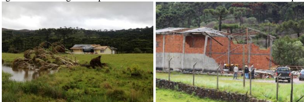
Figura 76. Danos gerados por um downburst ocorrido no interior de São Joaquim.
