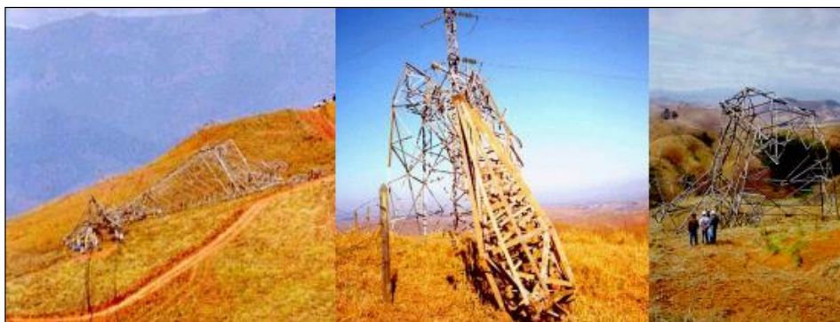
Figura 70. Estruturas da linha de transmissão de 500 kV danificadas em 22/07/2000.
