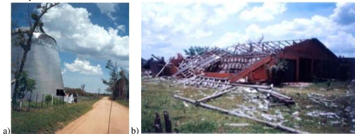
Figura 69. Fotos dos danos estruturais ocasionados pelo evento de downburst ocorrido no município de Viamão – RS.
