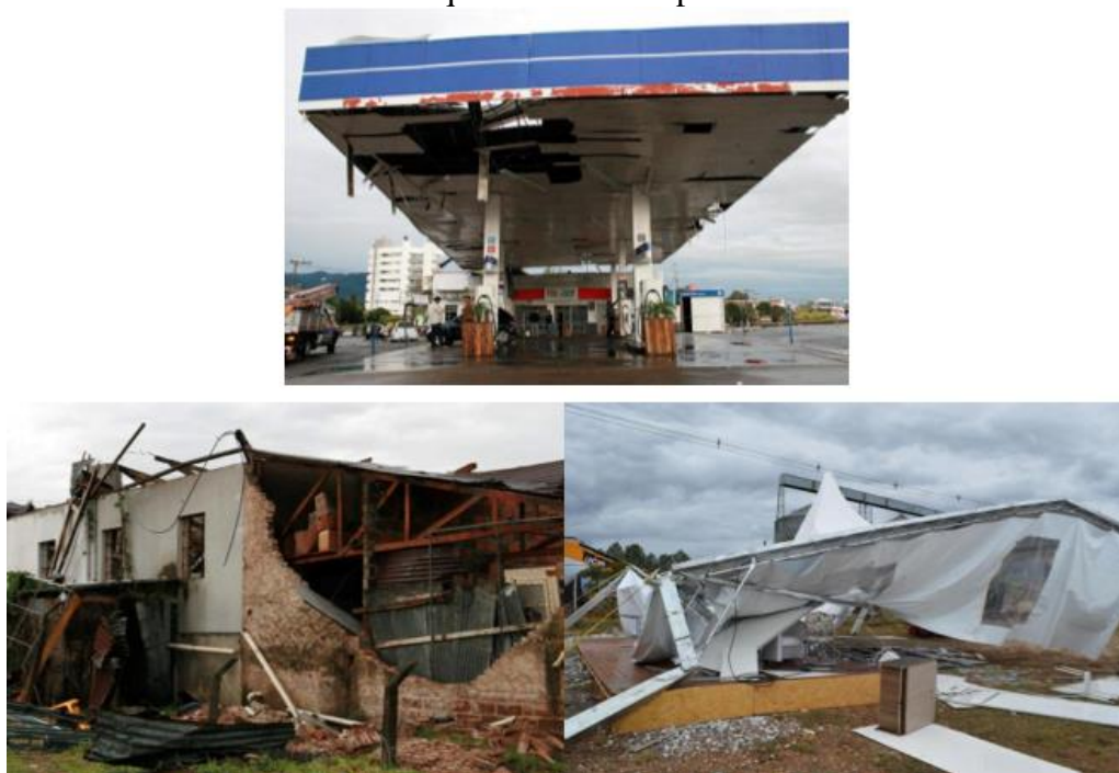
Figura 82. Os danos ocasionados pela linha de instabilidade que avançou sobre o norte do RS e o sul de SC em 29 de maio de 2013 que teve forte impacto sobre a sociedade.
