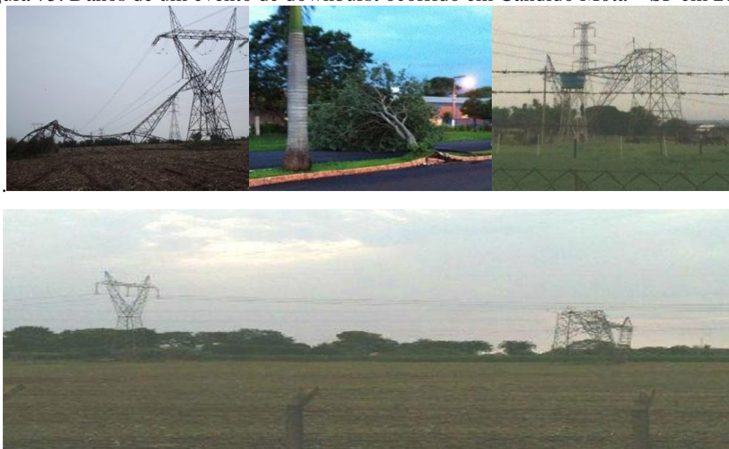
Figura 75. Danos de um evento de downburst ocorrido em Cândido Mota – SP em 2012.
