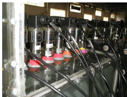
Figura 3.17 - Detalhe dos transdutores do teto do conduto.
