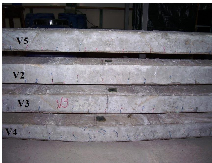
Figura 44: fissuração das vigas após o ensaio de longa duração
