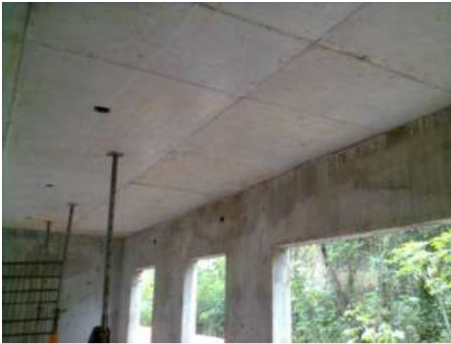
Figura 41 – Diferença de tonalidade em uma laje
