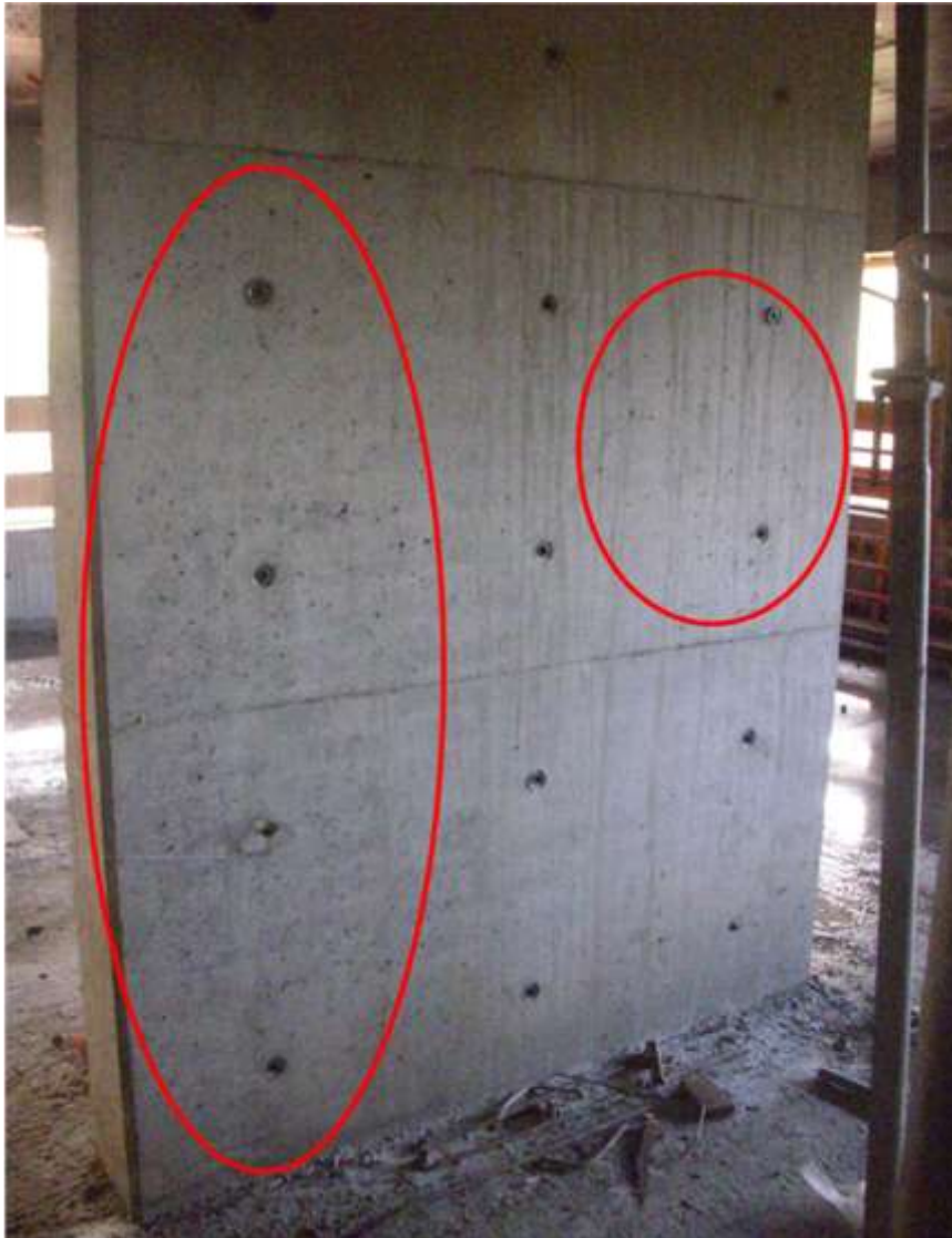
Figura 33 – Vista geral da incidência de bolhas em um pilar
