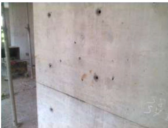
Figura 34 – Pequena concentração de vazios em um pilar
