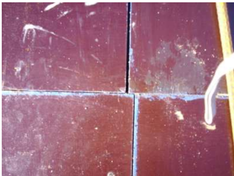
Figura 27– Detalhe das juntas desalinhadas e espaçadas
