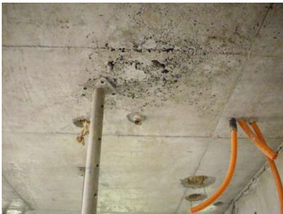
Figura 36 – Agregado exposto em uma laje
