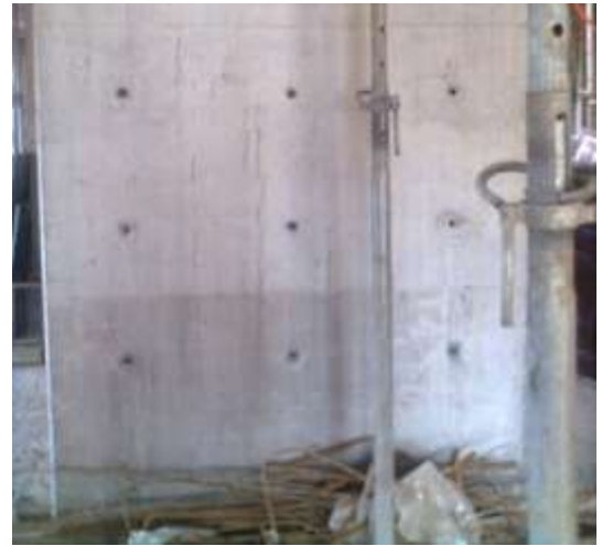
Figura 42 – Diferença de tonalidade em um pilar
