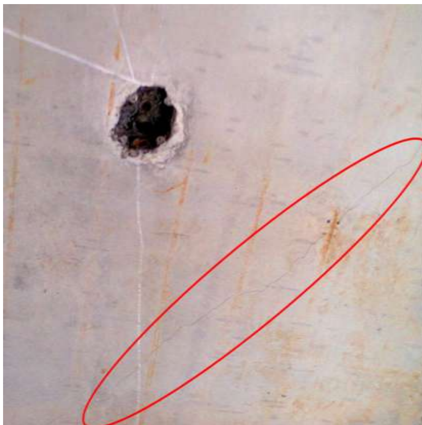
Figura 51 – Fissura de grande extensão em uma laje (0,30 mm de largura)
