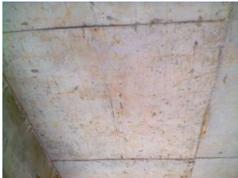
Figura 38– Manchas generalizadas em parte da laje concretado com compensado de reuso em comparação ao uso de compensado novo (à direita)
