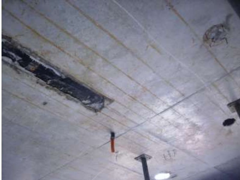
Figura 37– Manchas de oxidação devido à exposição à água da armadura da laje
