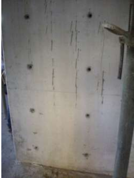
Figura 39– Manchas escuras ao longo do pilar
