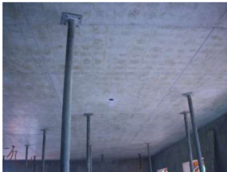
Figura 40– Sujeira impregnada na laje (“pegadas”) e consequente remoção do desmoldante
