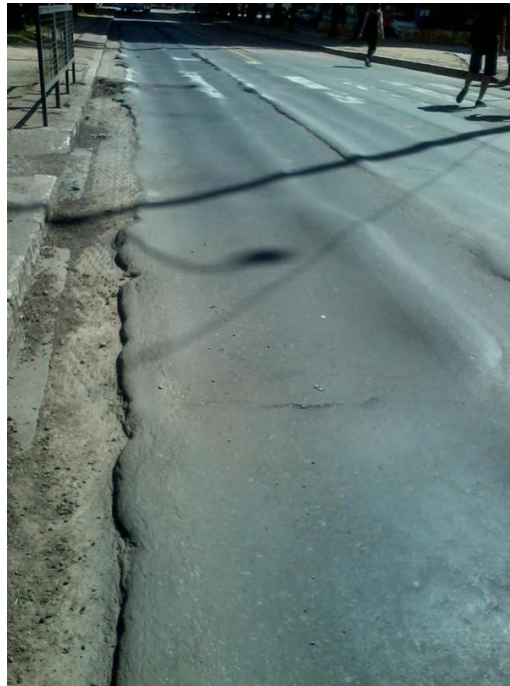
Figura 6 – Exemplo de deformação permanente no revestimento asfáltico
