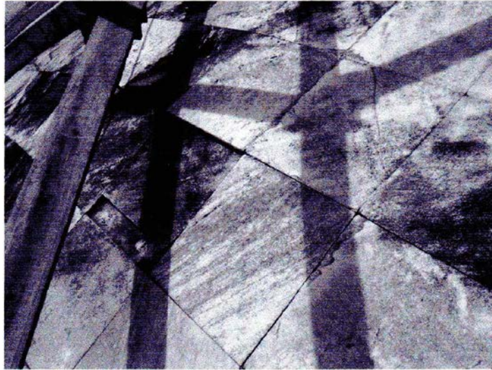
Figura 23 – Detalhe do desacoplamento das placas de revestimento na parte superior da Cúpula.
