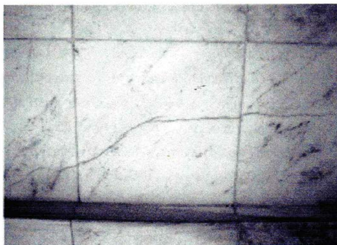
FIGURA 9 - Fratura de dilatação cortando três chapas de mármore de revestimento da Cúpula.
