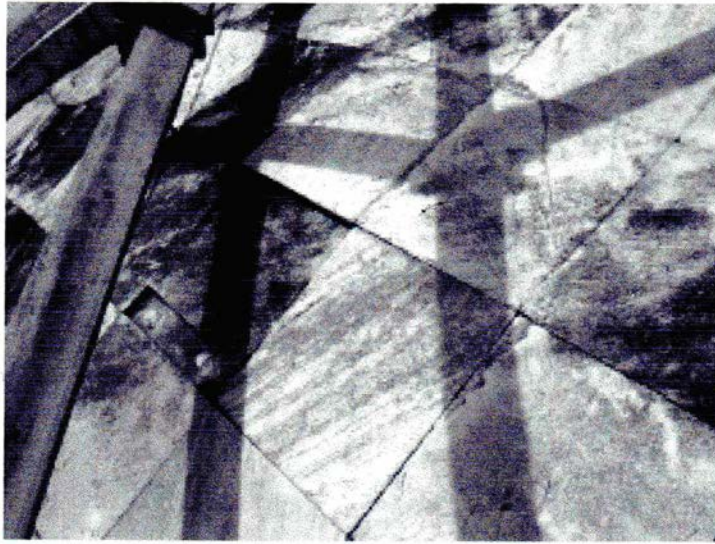
FIGURA 11 - Detalhe do deslocamento das placas de revestimento.
