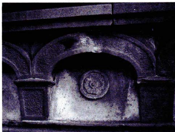
Figura 36 – Feições de deterioração da fachada do museu caracterizadas pela perda de material rochoso, com arredondamento e formação de um relevo áspero.
