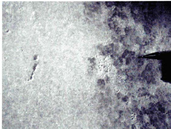
FIGURA 5 - Aspecto geral das chapas de mármore do revestimento da Cúpula ressaltando a estrutura granoblástica grossa e o início da dissolução dos cristais de calcita.
