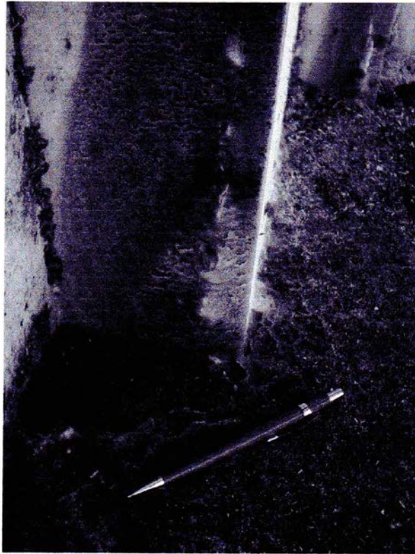
Figura 19 - Precipitação de cimento carbonático hidratado no contato entre a chapa de mármore e os granito do anel inferior do domo de sustentação da cúpula.
