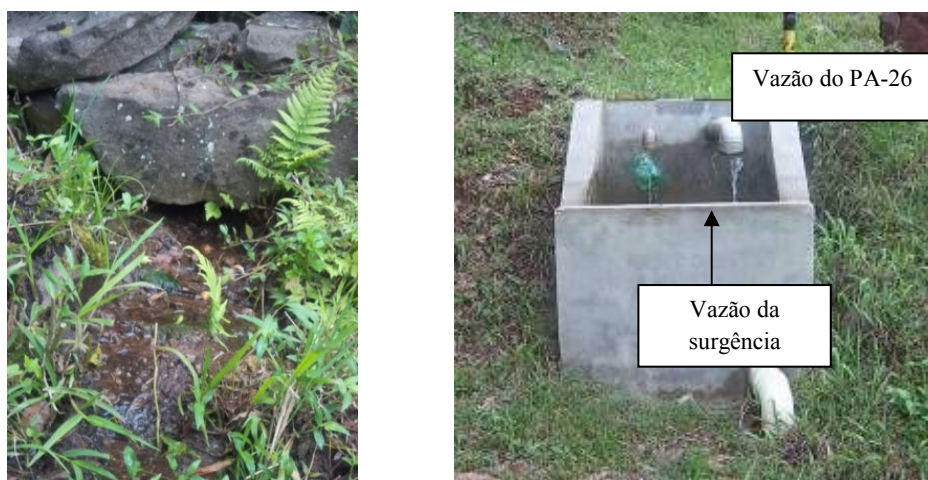
Figura 40: Surgência junto ao PA-27 e medidor de vazão de monitoramento da surgência e vazão do dreno PA-26
