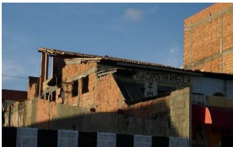
Figura 17 - Espaço do Grupo Zimba na Rua Carimbamba, com a estrutura física danificada (foto minha)
