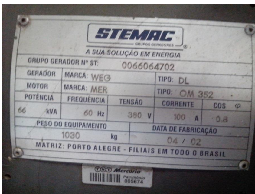
Figura 7 – Placa de identificação do gerador.
