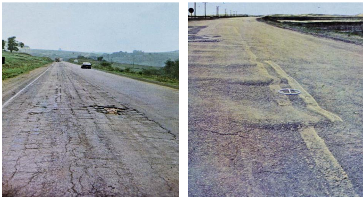
Figura 2 – Defeitos em pavimentos flexíveis
