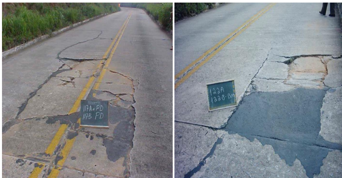
Figura 3 – Defeitos em pavimentos rígidos
