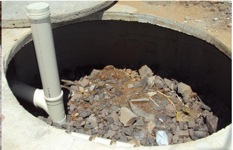
Figura 22 – Sujeira e terra dentro do filtro anaeróbio
