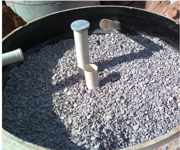
Figura 20 – Brita muito pequena para preenchimento do leito do filtro
