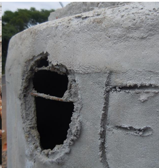
Figura 7 – Espessura insuficiente na parede de um tanque
