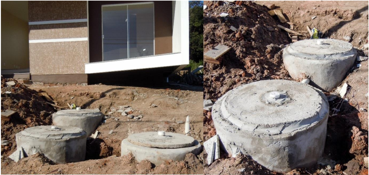
Figura 31 – Sistema sem acesso para inspeção
