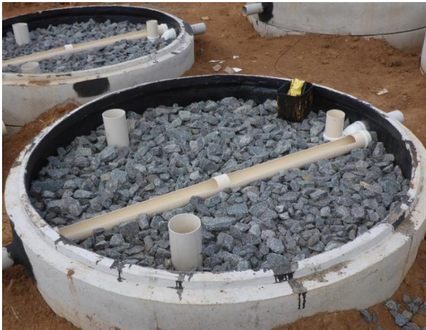
Figura 16 – Filtro Anaeróbio sem desnível entre tubulações de entrada e saída
