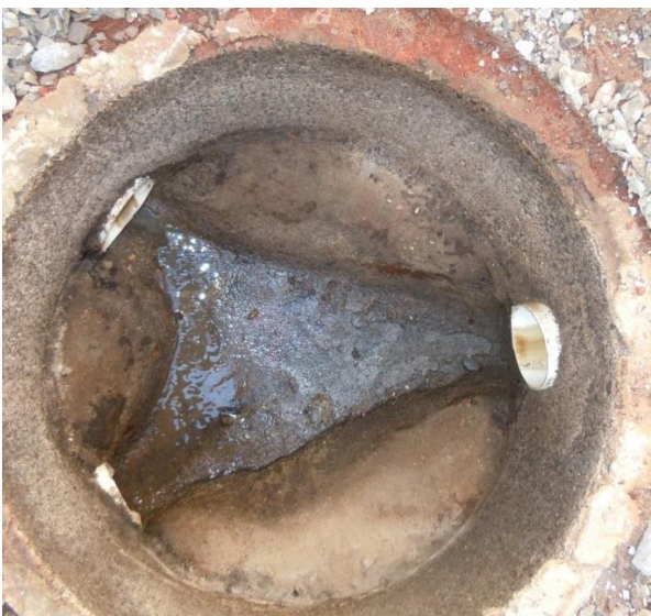
Figura 25 – Divisão de esgoto não recomendada em uma caixa de divisão
