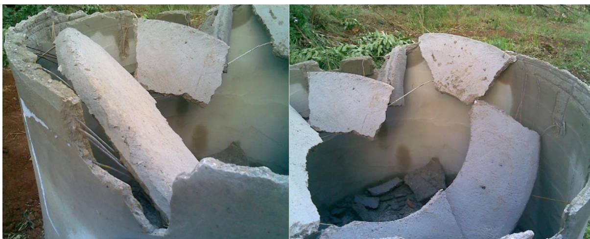
Figura 8 – Ruptura da uma tampa estruturalmente inadequada
