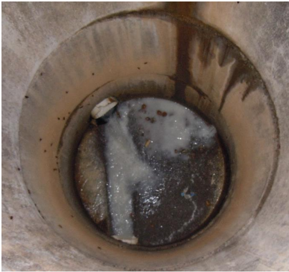
Figura 29 – Infiltração em caixa de inspeção em pré-moldado
