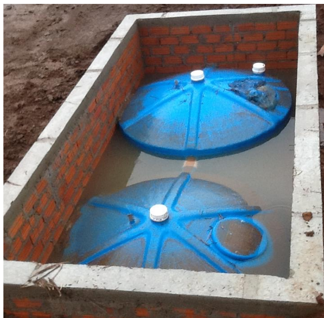
Figura 15 – Tanques plásticos protegidos por parede em alvenaria
