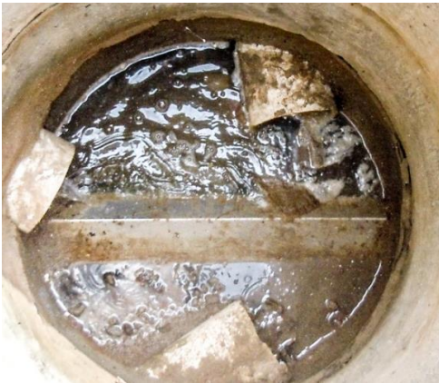
Figura 23 – Divisão incorreta do efluente em uma caixa de divisão
