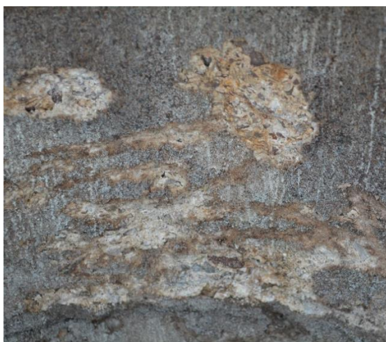
Figura 11 – Ataque por sulfato na parede de um tanque
