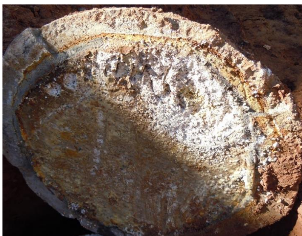
Figura 9 – Ataque por sulfato em uma sobretampa
