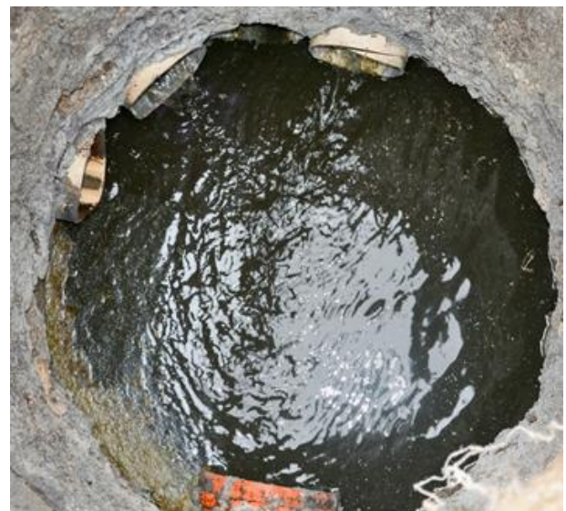
Figura 26 – Caixa de união recebendo má distribuição do efluente
