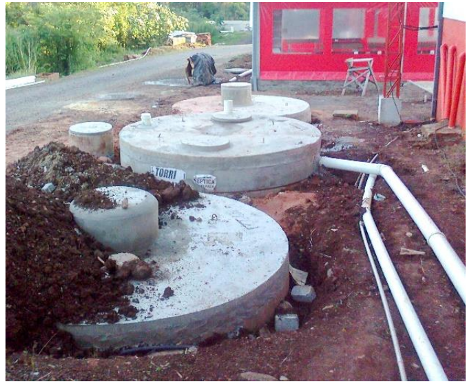
Figura 33 – Tanques sépticos e filtros anaeróbios com chaminé de inspeção em pré-moldado
