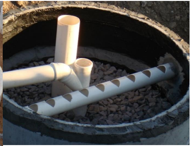
Figura 17 – Filtro Anaeróbio com desnível entre tubulações de entrada e saída
