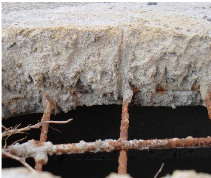
Figura 6 – Cobrimento insuficiente da armadura na tampa de um tanque
