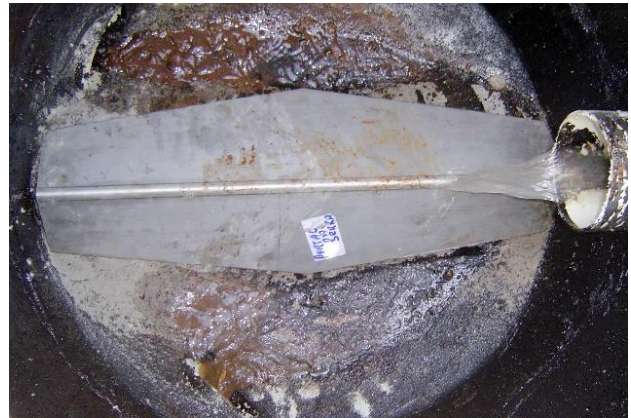
Figura 24 – Divisão correta do efluente em uma caixa de divisão
