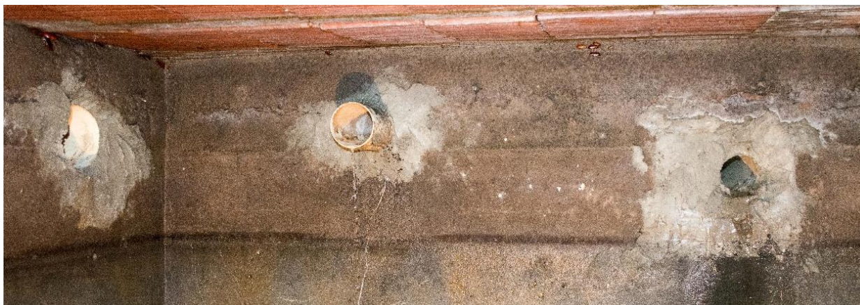
Figura 28 – Tubulação de água pluvial ligada ao tanque séptico
