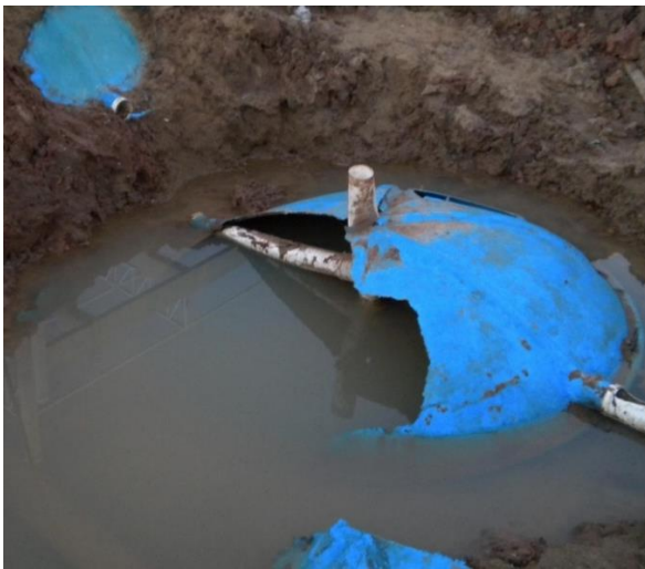
Figura 13 – Tanque plástico rompido
