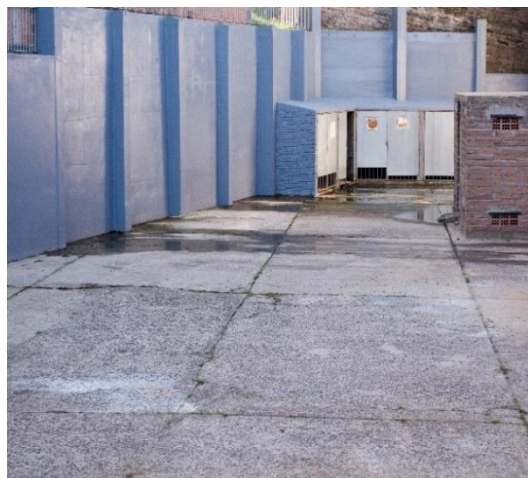
Figura 5 – Afloramento do esgoto através de um muro de arrimo
