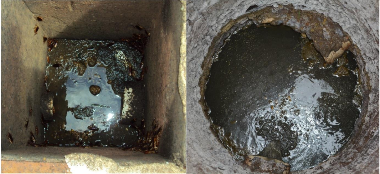
Figura 18 – Caixas de inspeção com esgoto represado
