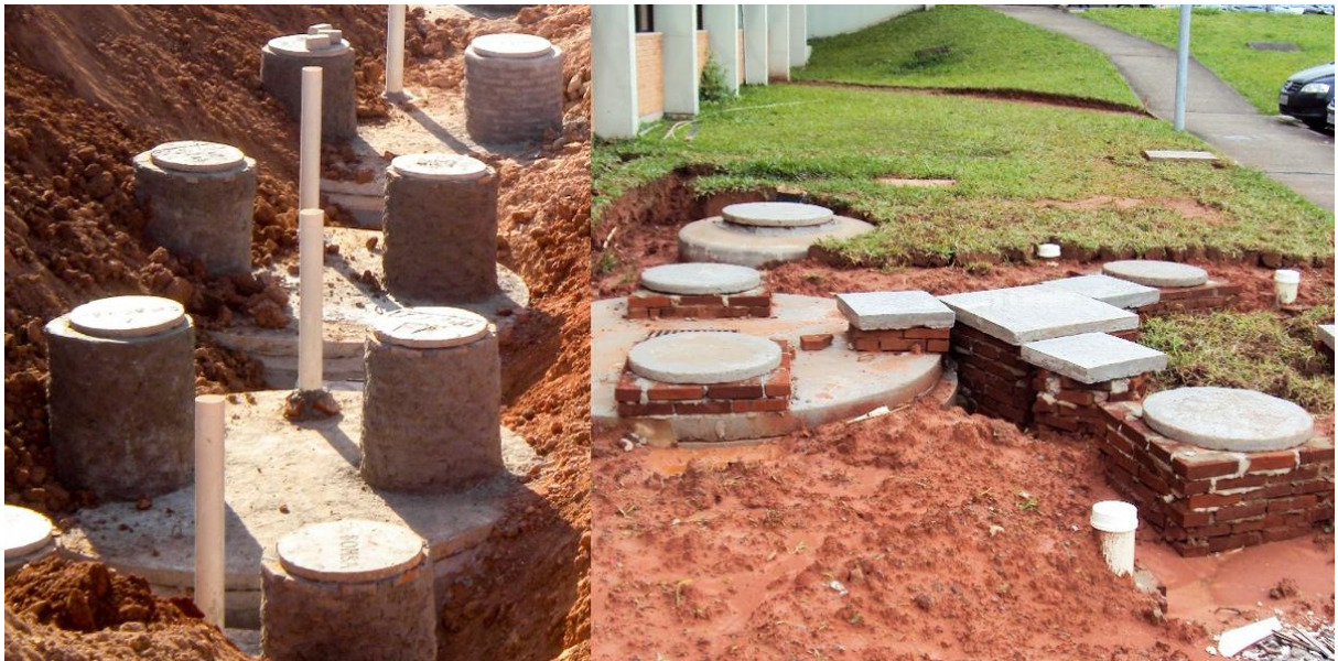
Figura 34 – Tanques sépticos e filtros anaeróbios com chaminé de inspeção em alvenaria
