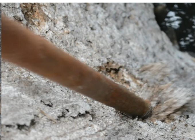
Figura 12 – Ataque muito severo por sulfato na parede de um tanque
