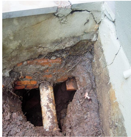
Figura 30 – Infiltração em caixa de inspeção em alvenaria
