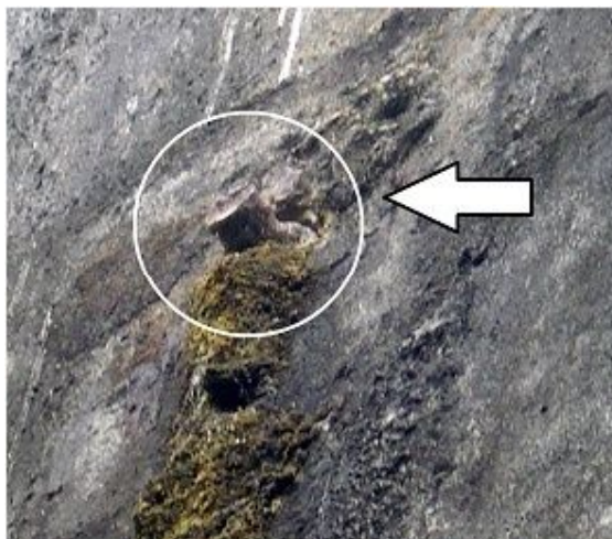
Figura 22 - Exemplo de ruptura do tirante com contração da barra
