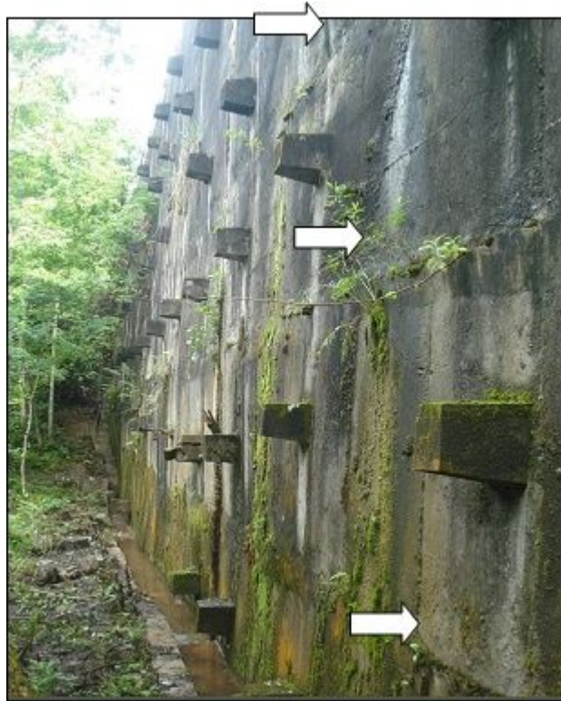
Figura 28 - Exemplo de diversas patologias em juntas horizontais
