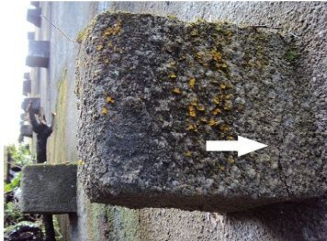
Figura 13 - Exemplo de fissuras
