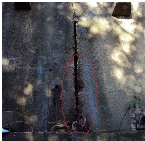
Figura 26 - Exemplo de fuga de finos
