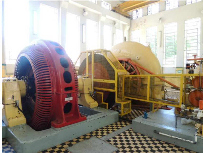
Figura 16. Turbina Hidráulica e Gerador
