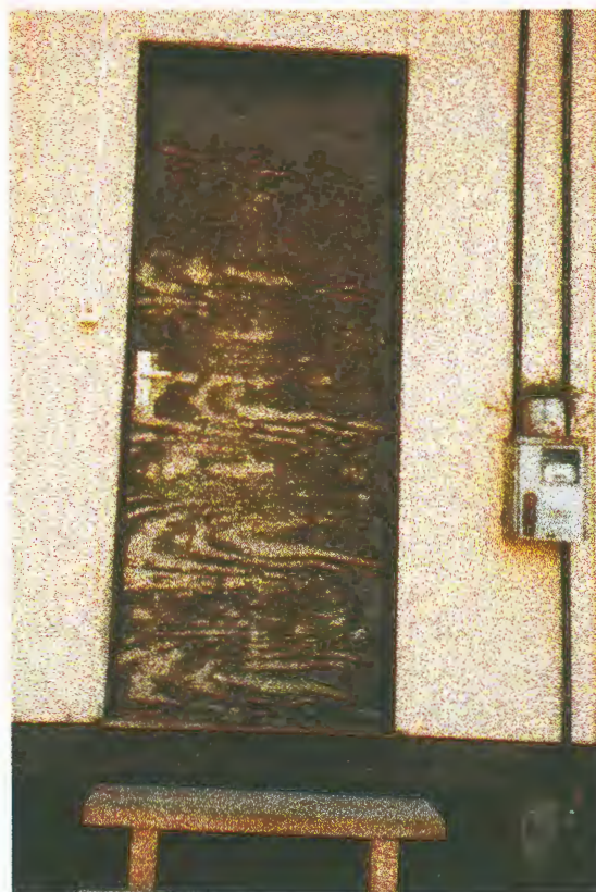
Figura 18: Exemplo de defeito verificado nas portas externas.
