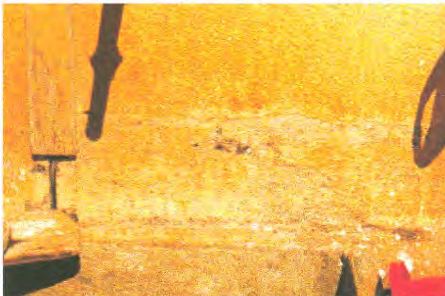
Figura 15: Exemplo do defeito na pintura verificado na superfície dos painéis coincidente com a presença do tanque de lavar roupas.
