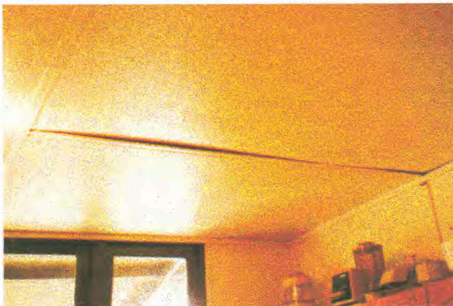
Figura 22: Exemplo do defeito verificado no forro.
