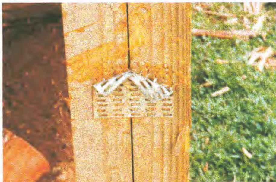
Figura 12: O arrancamento do conector metálico permite ver o perfeito estado de conservação da madeira.
