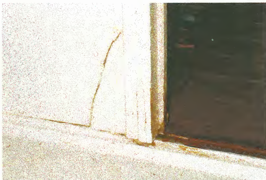
Figura 20: Exemplo de rachadura existente na placa de fibrocimento dos painéis para banheiro.
