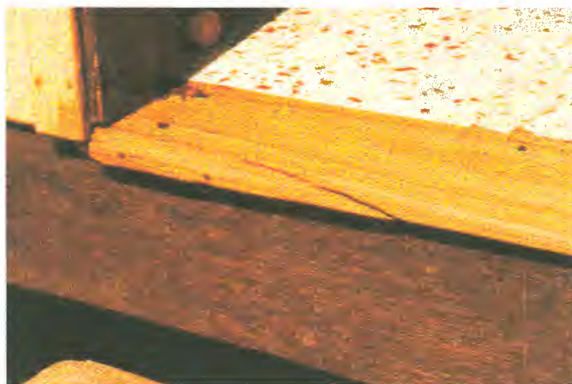
Figura 16: Exemplo do defeito verificado nas soleiras.
