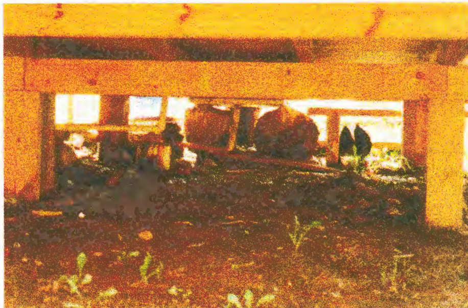
Figura 11: Vista parcial dos pilares, vigas de fundação, estrutura de suporte do assoalho bem como da face inferior das tábuas que o conformam.
