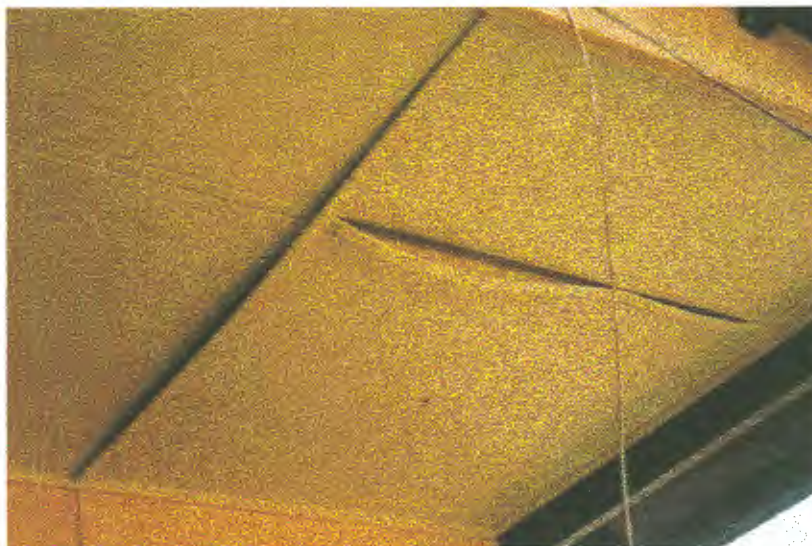
Figura 19: Exemplo de defeito encontrado em forro de varanda .
