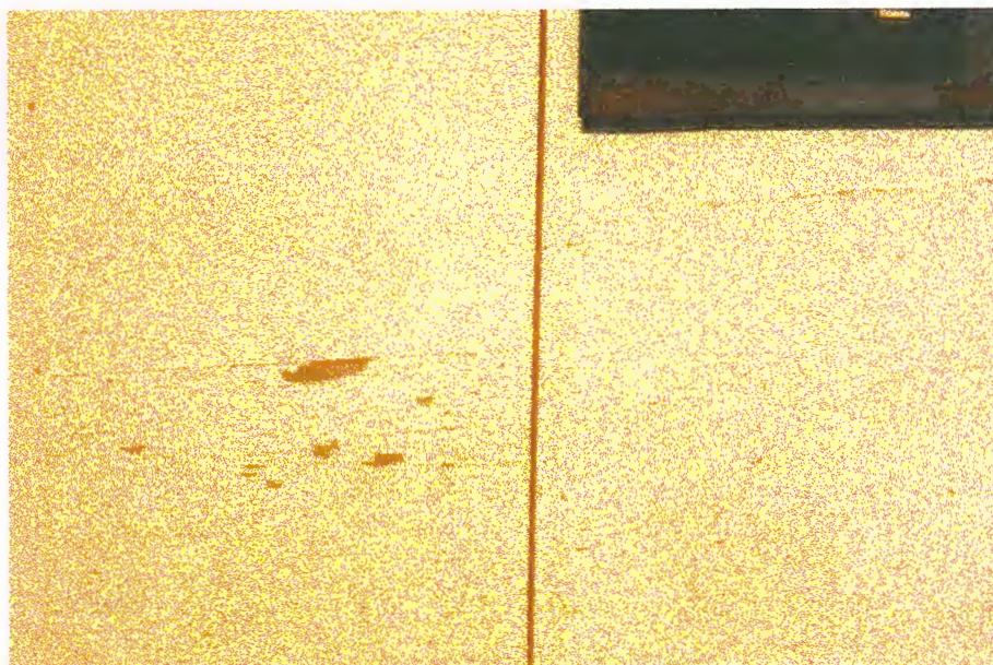
Figura 13: Exemplo de defeito na pintura verificado na superfície dos painéis.
