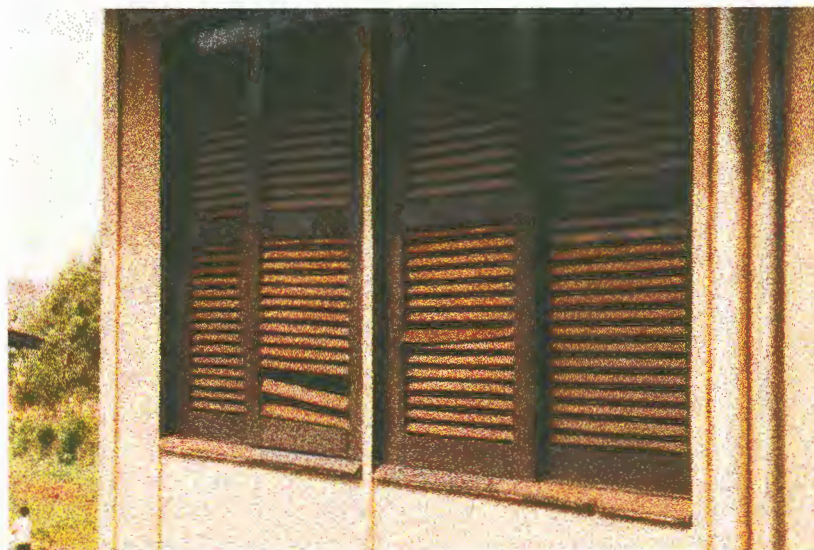
Figura 17: Exemplo do defeito encontrado nas janelas.
