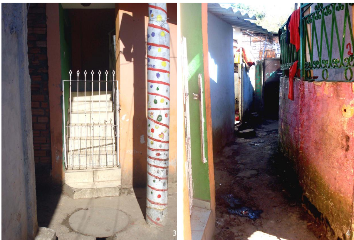
Figura 2.25 Escada e poste. Figura 2.26 Fissura. Fonte: Autora.
