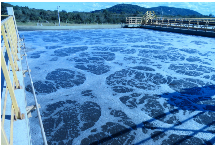
Figura 6. Tanque de lodo ativado com aeração (Unitank) da ETE Serraria.
