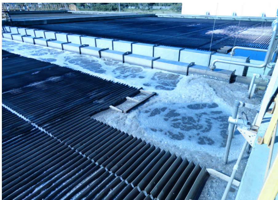
Figura 7. Detalhe das lamelas que auxiliam na decantação no Unitank da ETE Serraria.
