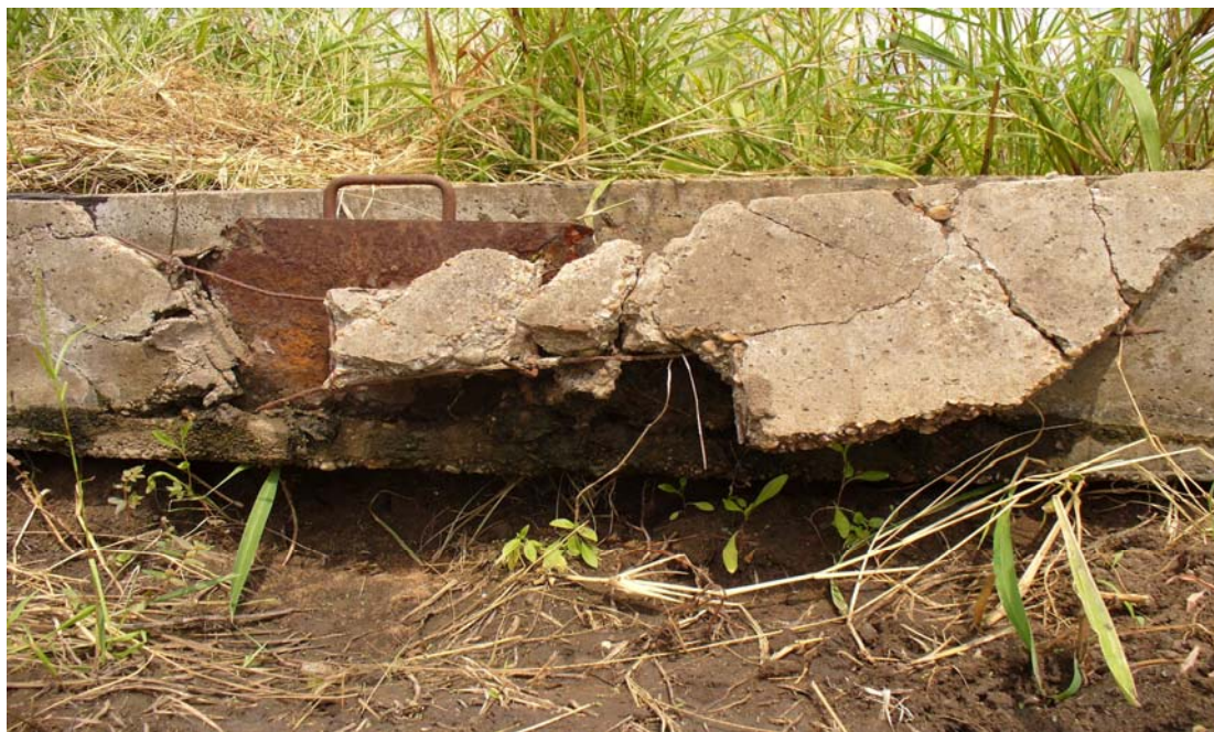
Foto 13: Estado avançado de degradação das caleras Fonte: do Autor
