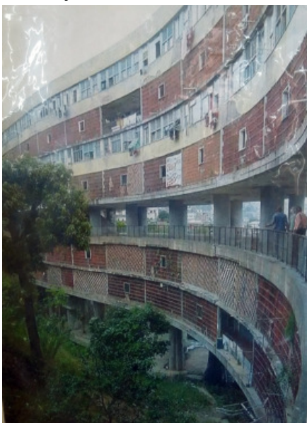
ABAIXO: Fotografia exposta na Associação de Moradores do Conjunto Pedregulho, demonstrando a situação da fachada leste do Bloco A em 2005.
