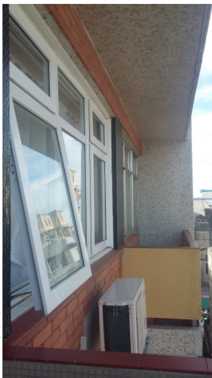
ACIMA: Em primeiro plano, janela anti-ruído instalada nos quartos de um dos apartamentos, ao fundo, janela de alumínio original do Jaguaribe.
