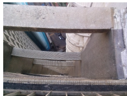
ACIMA: Situação das pastilhas se desprendendo na fachada posterior do Copan.
