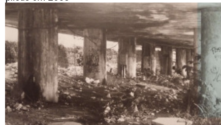
ACIMA: Situação degradante do pav. térreo do conjunto, em parte causada pelo mau uso do sistema de esgotamento sanitário.
