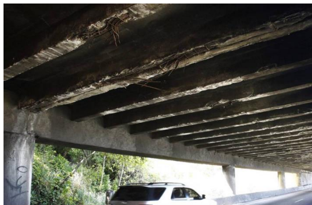
Figura 2 – Estrutura de concreto armado severamente corroída, com armadura aparente, no Elevado do Joá, no Rio de Janeiro.
