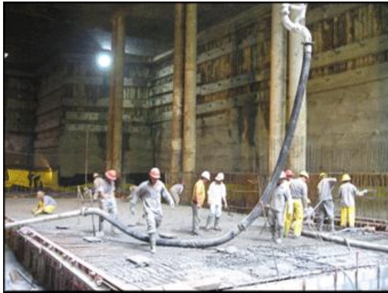
Figura 3: Concretagem do Bloco 3 da Estação Faria Lima – Linha 4 Amarela em São Paulo (METRÔ, 2006).
