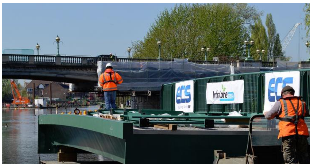
Figura 1. Imagens da ponte de pedestres sendo substituída por uma ponte de FRP na cidade de Mapledurham – UK [Composites Manufacturing Magazine, 2017].
