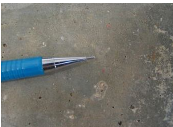
Figura 108: CP40 aos 1337 dias de idade: superfície do concreto coberta por pó de coloração marrom e branca (eflorescência branca) e pontos de oxidação.
