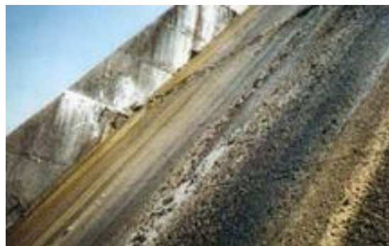
Figura 10: Paramento de jusante da barragem do Rio Descoberto com vazamentos e deterioração do concreto (KFFURI, 2003).
