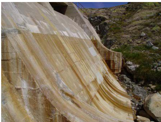
Figura 5: Manchas marrom na superfície de concreto da barragem de Rumedo (ARAÚJO, 2008).
