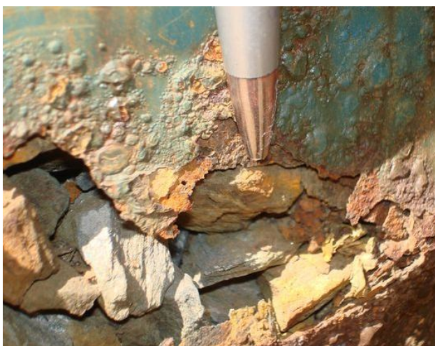
Figura 34: Tambor de aço corroído contendo agregados com sulfetos alterados.
