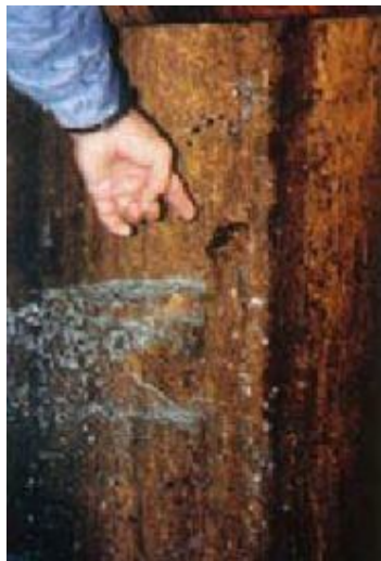
Figura 9: Intensos vazamentos ao longo da parede da galeria da barragem do Rio Descoberto (KFFURI, 2003).
