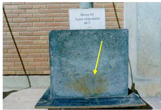
Figura 4: Manchas de cor marrom sobre a superfície do concreto (HASPARYK et al., 2002).
