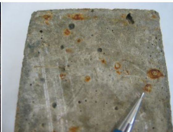
Figura 107: CP40 aos 1337 dias de idade: superfície do concreto com aspecto esbranquiçado, com pontos de oxidação e manchas de ferrugem.
