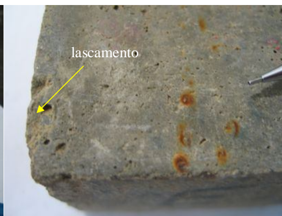
Figura 113: CP60 aos 2038 dias de idade: superfície do concreto com manchas de ferrugem e com arestas lascadas ou corroídas.
