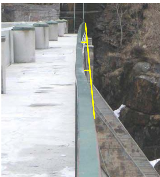
Figura 7: Deslocamento estrutural observado na barragem de Graus que provocou uma curvatura, em torno de 8 cm, em uma estrutura metálica de proteção disposta sobre o concreto (ARAÚJO, 2008).
