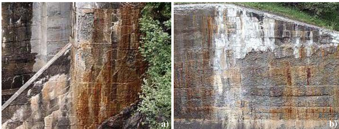
Figura 19: a) Pilar e b) parede da Barragem de Graus, Espanha, apresentando manifestações patológicas típicas do processo de oxidação de sulfetos de ferro: manchas de ferrugem, eflorescências e fissuras (ARAÚJO, 2008).
