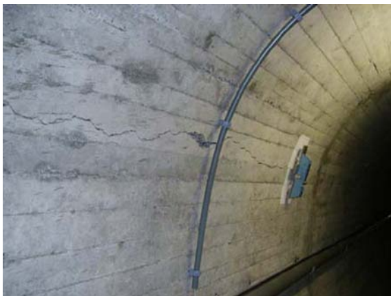
Figura 1: Fissura do tipo orientada na parede de uma galeria da barragem de Rumedo, na Espanha (ARAÚJO, 2008)
