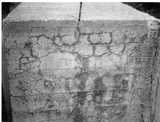
Figura 30: Bloco de concreto extraído da barragem de Graus revelando manifestações patológicas típicas do fenômeno de oxidação dos sulfetos de ferro: manchas de ferrugem e fissuração superficial mapeada (MIEZA, 1998).
