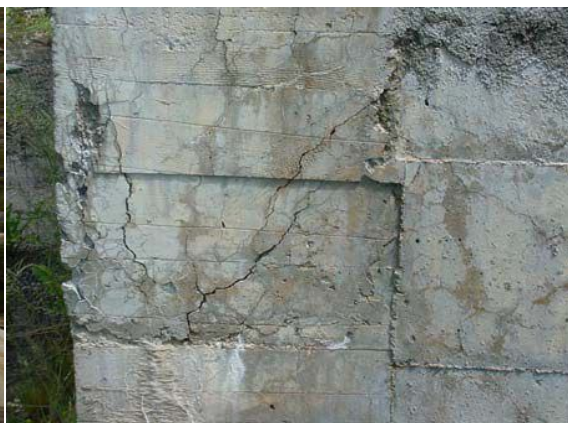
Figura 6: Fissuração de uma parede de concreto da barragem de Graus (ARAÚJO, 2008).
