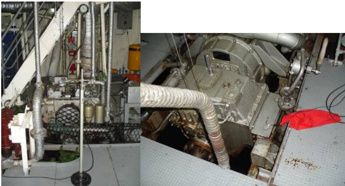
Figura 5.7 – Ponto de medição na praça de máquinas no Motor Central - MC.
