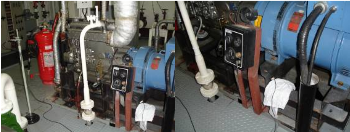
Figura 5.10 – Ponto de medição na praça de máquinas no Gerador Direito - GD.
