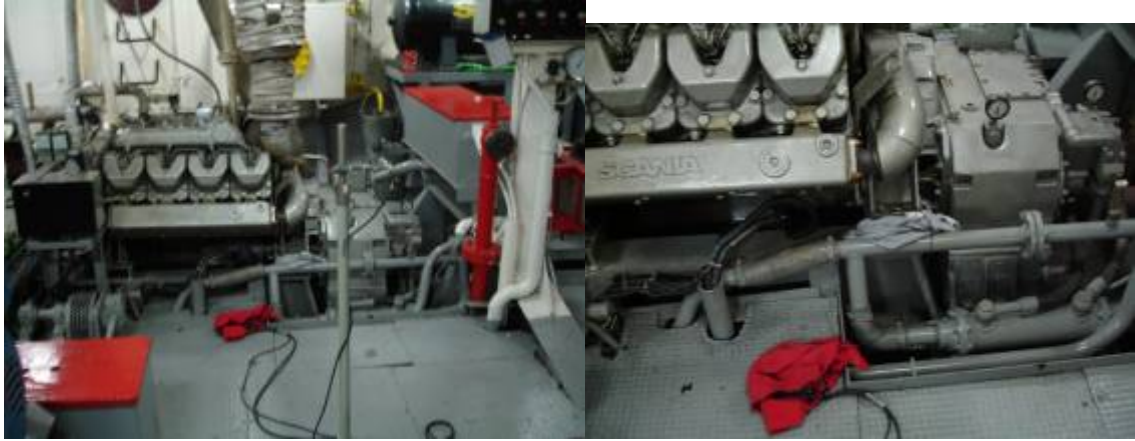
Figura 5.8 – Ponto de medição na praça de máquinas no Motor Direito - MD.
