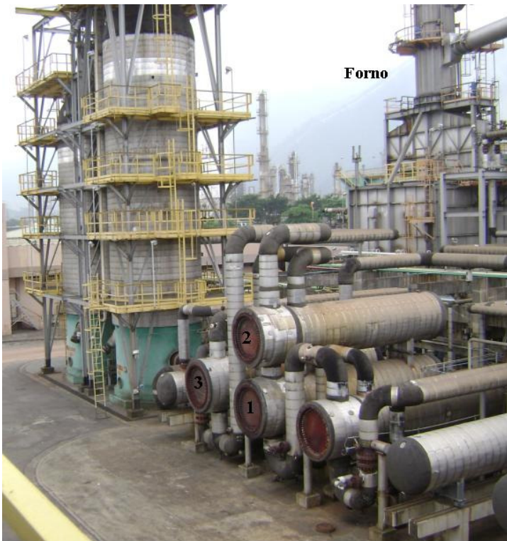
Figura 3.2 - Permutadores de calor e forno da bateria de pré-aquecimento [RPBC, 2009].
