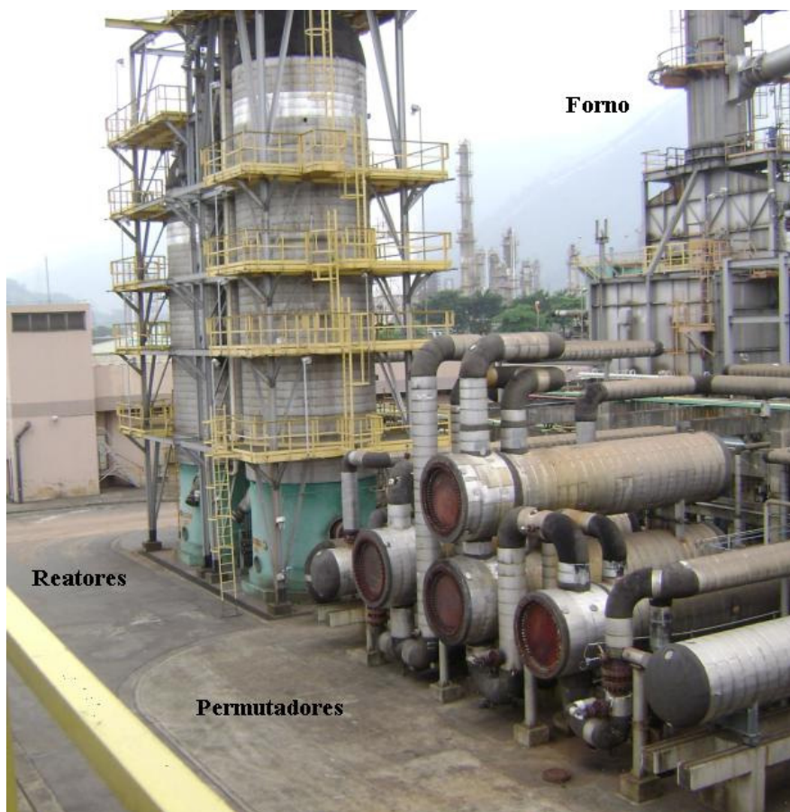
Figura 3.1 - Unidade de Hidrotratamento [RPBC, 2009].
