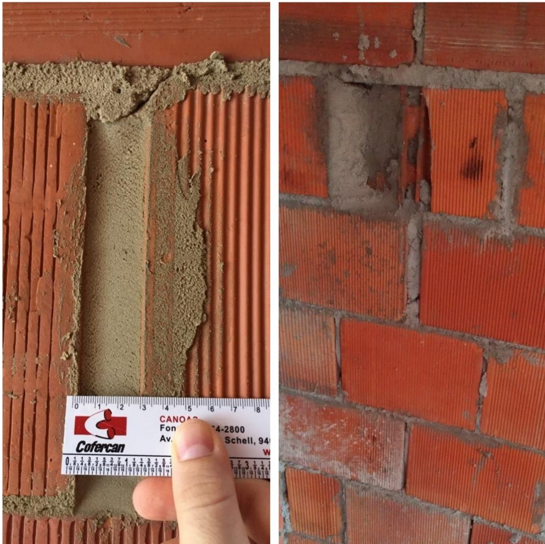
Figura 52 – Juntas de argamassa com espessura variável nas obras A e B
