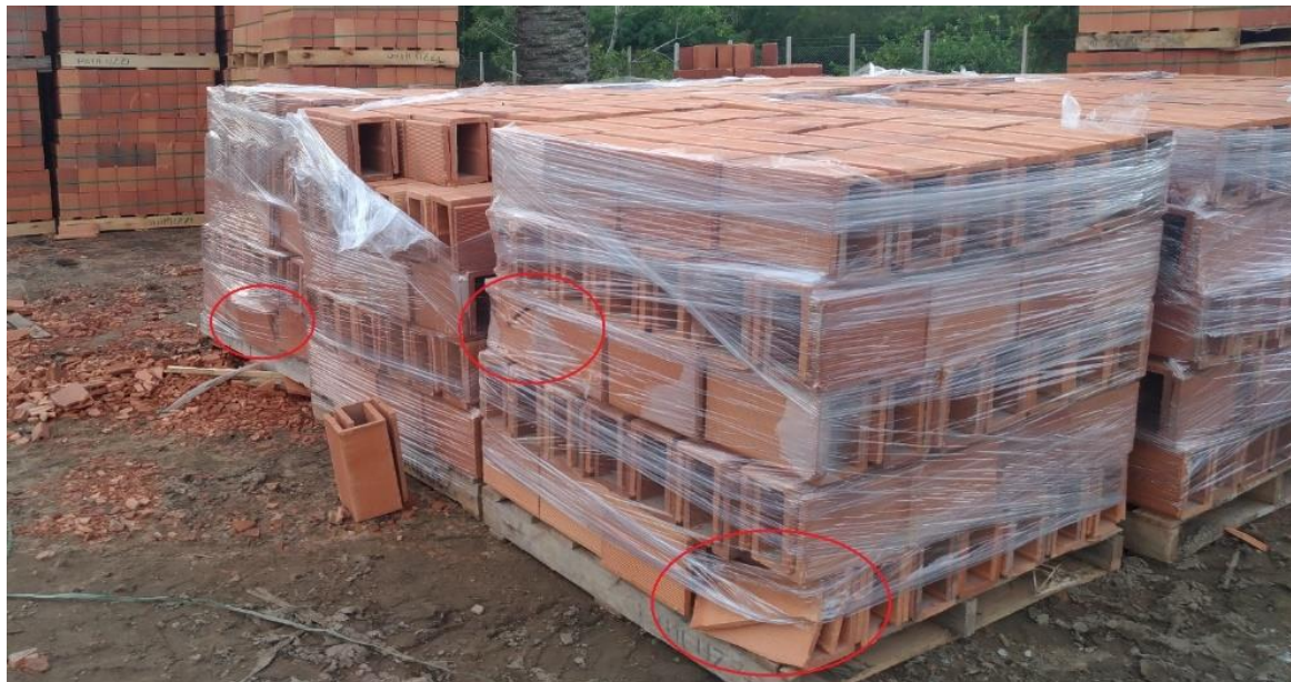
Figura 50 – Blocos fissurados e com fraturas na obra B
