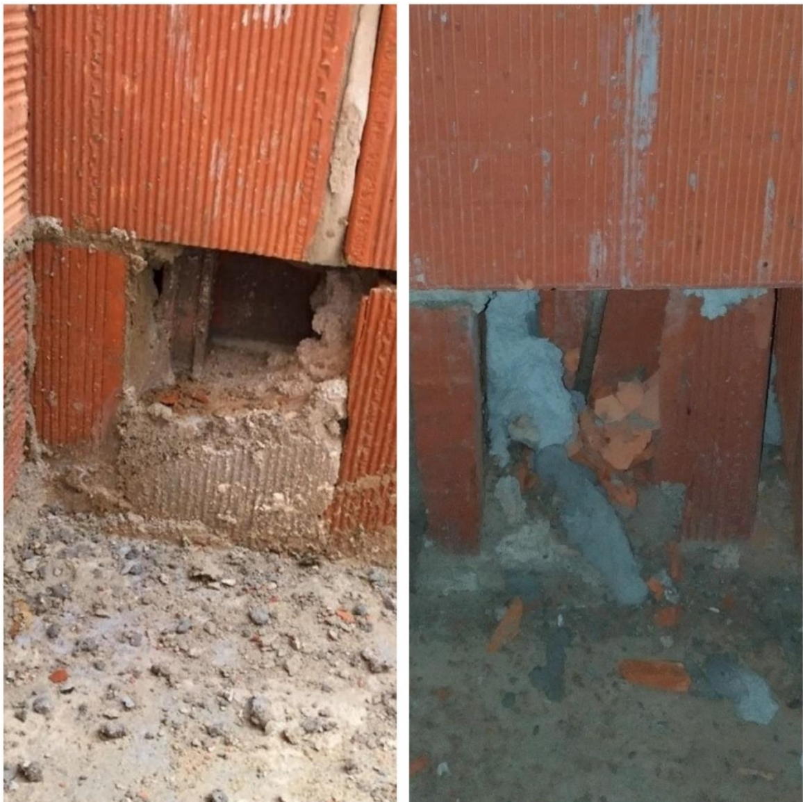
Figura 54 – Janelas de inspeção com falhas de preenchimento nas obras A e B
