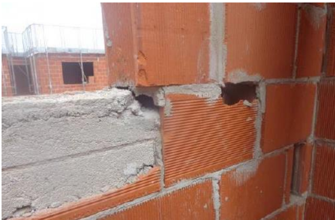
Figura 57 – Contraverga com apoio lateral oco em parede da obra A
