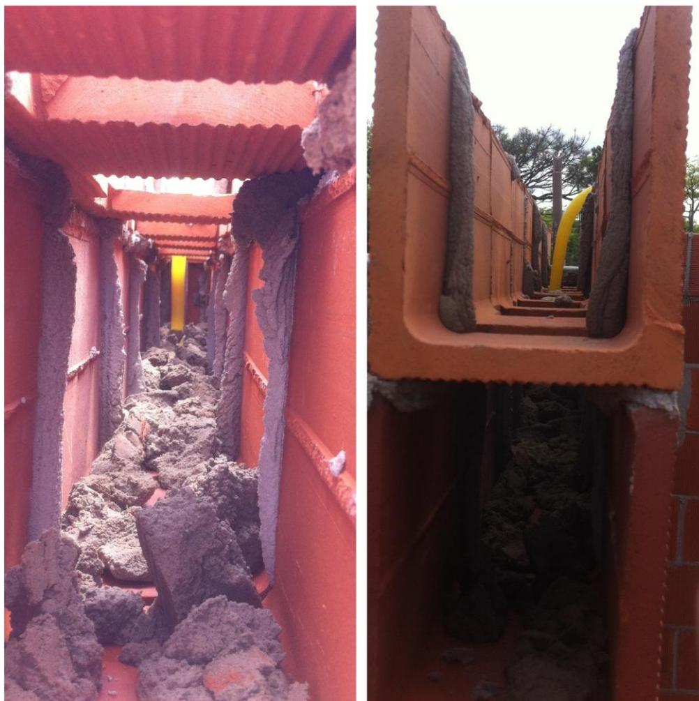
Figura 59 – Blocos canaleta (cinta de respaldo) com resíduos de argamassa
