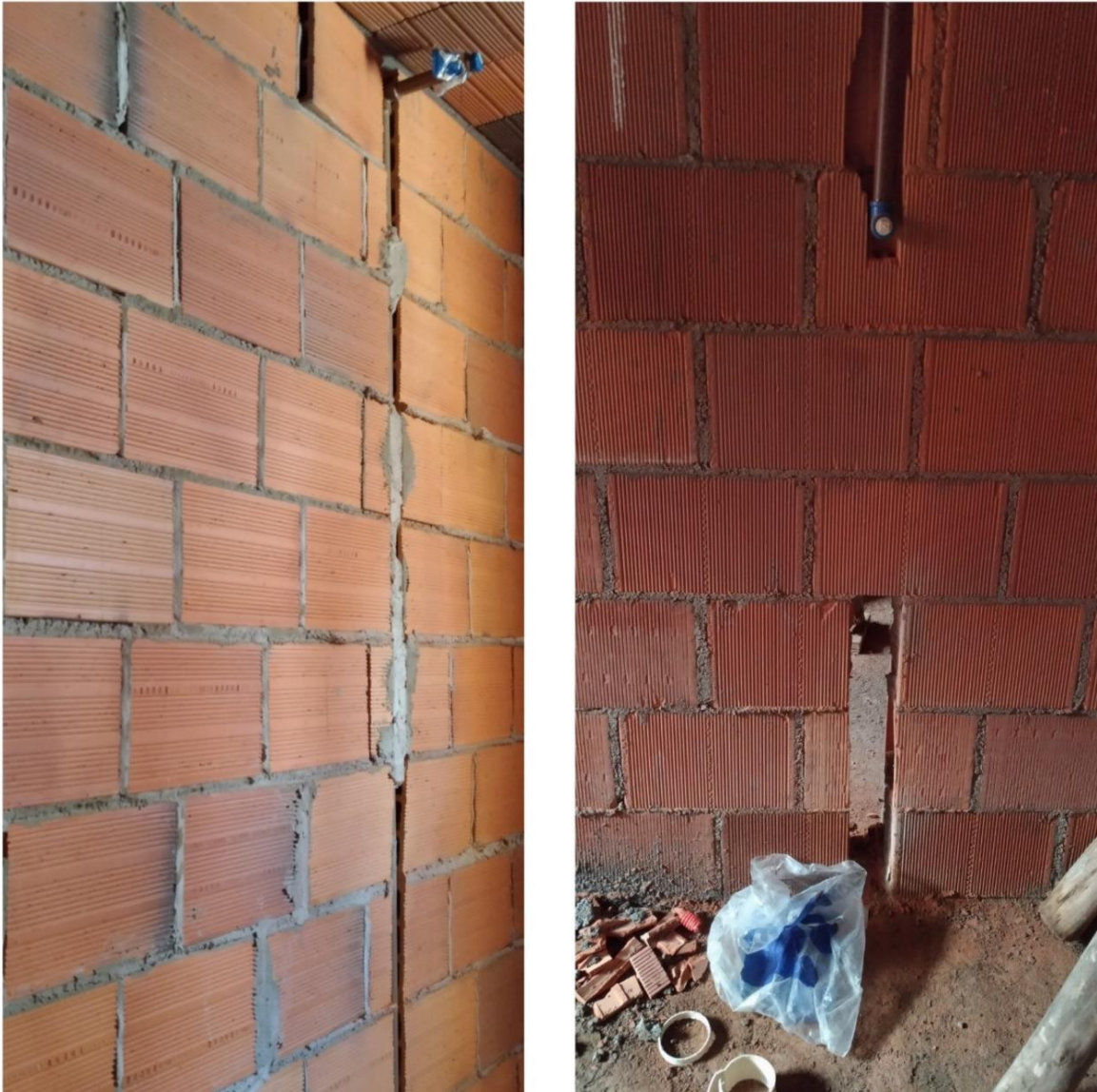
Figura 56 – Rasgos nas paredes das obras A e B
