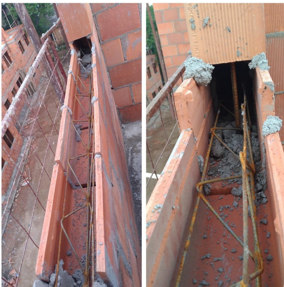
Figura 58 – Blocos canaleta (contravergas) com resíduos de argamassa
