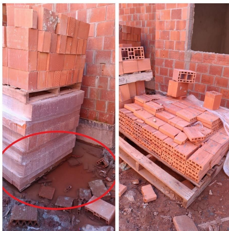
Figura 51 – Blocos em contato com água e armazenados de forma inadequada
