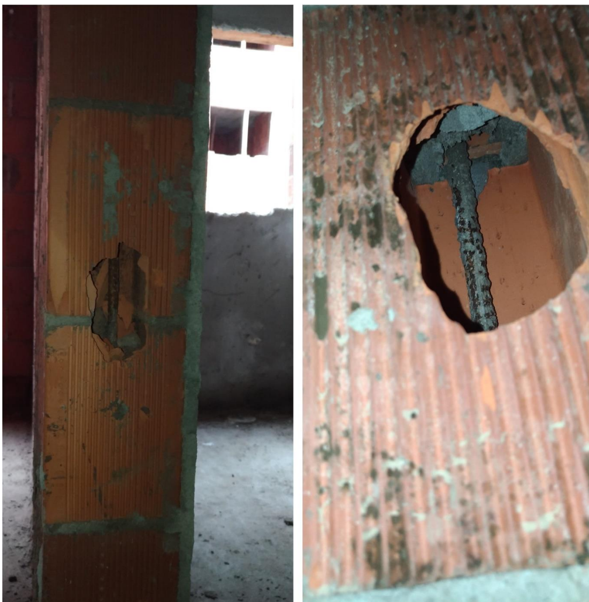
Figura 55 – Ausência do ponto de graute na obra B
