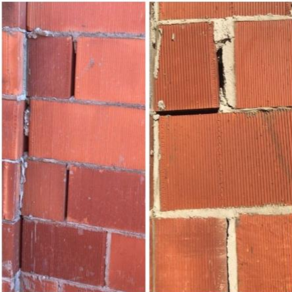
Figura 53 – Falhas no preenchimento de juntas de argamassa na obra A
