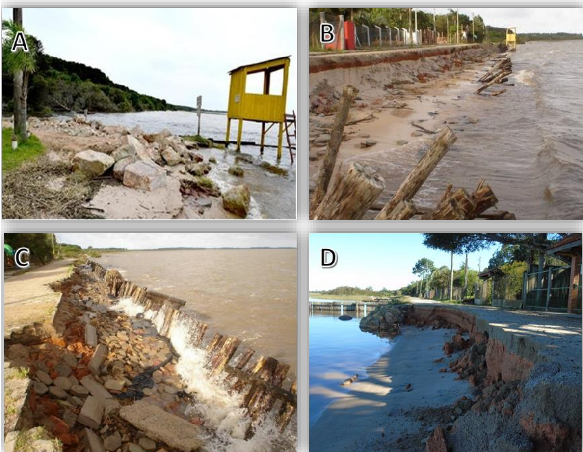
Figura 51 – Processos Erosivos na Praia do Jacarezinho, Tapes (RS).
