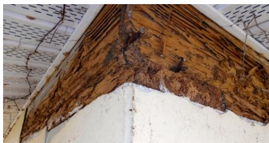
Figura 7 – Viga de madeira atacada por cupins
