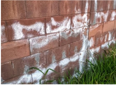
Figura 11 – Eflorescências, causada pela presença de sais nos blocos de alvenaria
