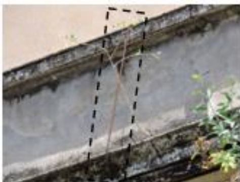
Figura 35 – Cordoalha na platibanda
