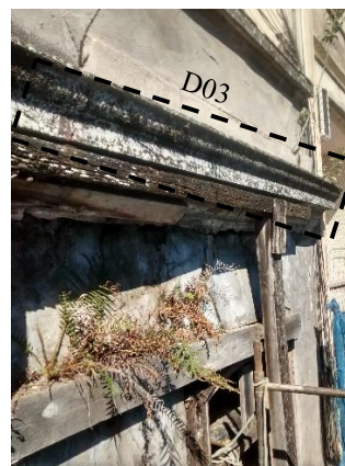
Figura 41 – Registro mais aproximado da cimalha e vegetação na fachada
