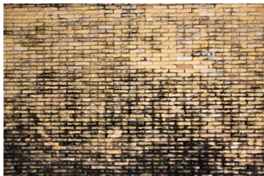
Figura 13 – Alvenaria atacada por fungos
