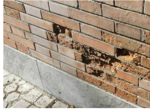
Figura 12 – Desagregação dos tijolos por criptoflorescência
