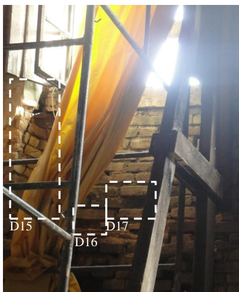
Figura 54 – Trinca na parede em estudo
