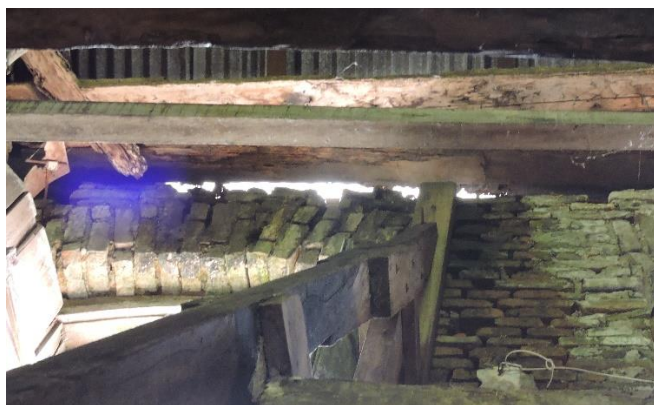
Figura 59 – Parte superior da face interna esquerda da parede da fachada
