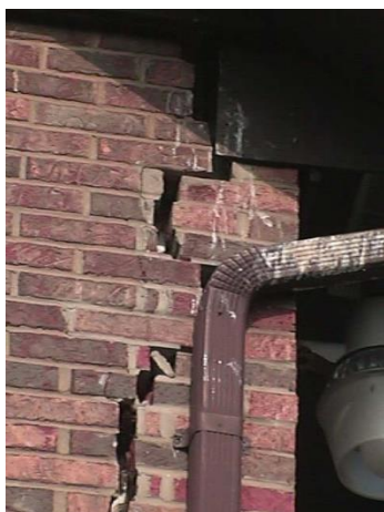
Figura 9 – Alvenaria com trincas causadas pela falta de amarração
