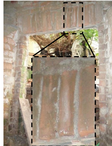
Figura 79 – Manchas causadas por musgos e eflorações na argamassa
