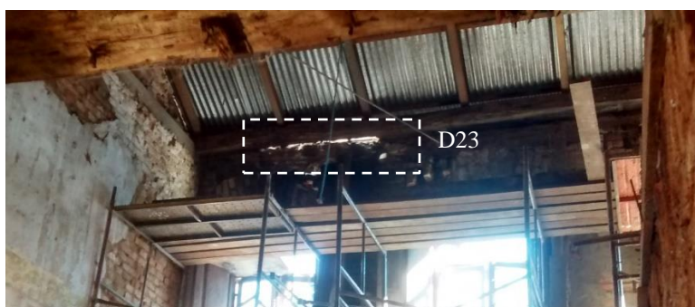
Figura 58 – Abertura e consequente degradação da calha da edificação
