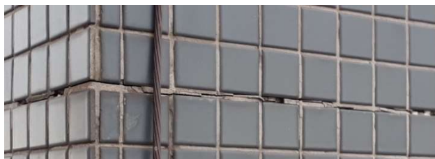
Figura 22 – Rejunte deteriorado ou ausente
