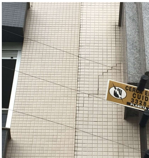
Figura 20 – Fissura na fachada
