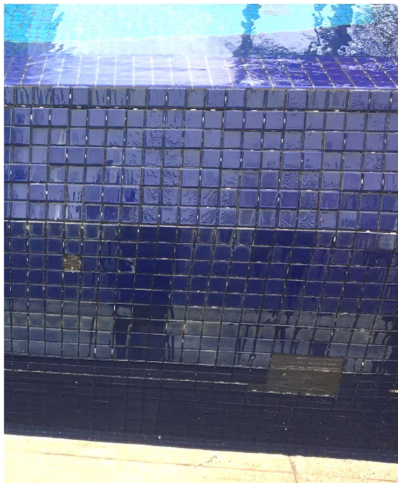
Figura 30 – Desplacamentos na piscina
