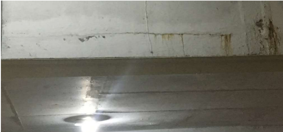
Figura 34 – Empolamento da pintura e manchamento por umidade
