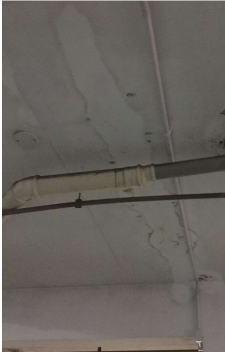
Figura 32 – Manchamento por infiltração
