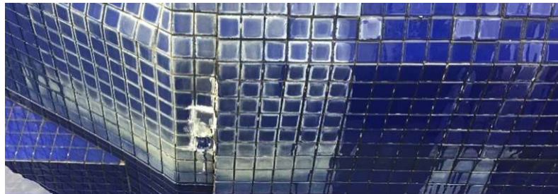
Figura 29 – Eflorescência na piscina
