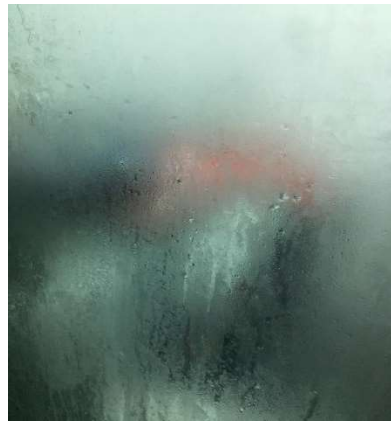
Figura 2 – Umidade de condensação
