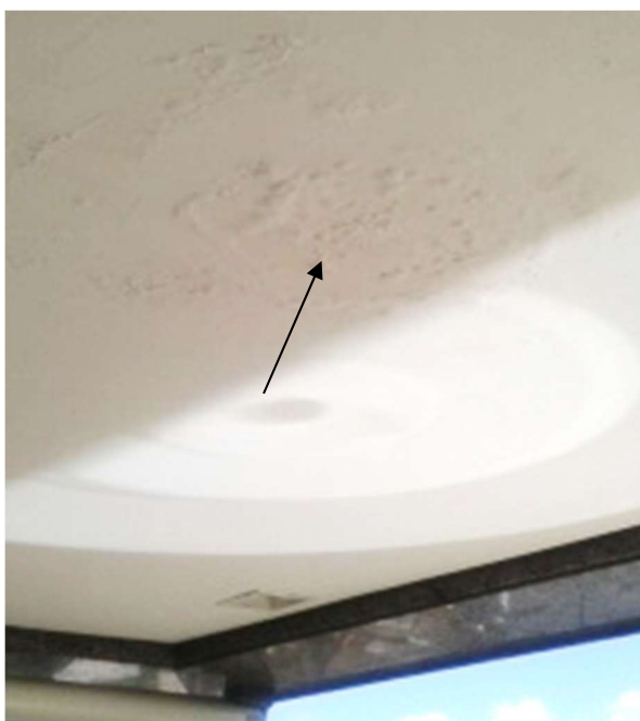
Figura 36 – Bolhas oriundas de água da laje em apartamento
