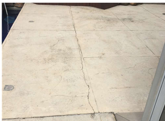
Figura 35 – Fissura no piso próximo à piscina
