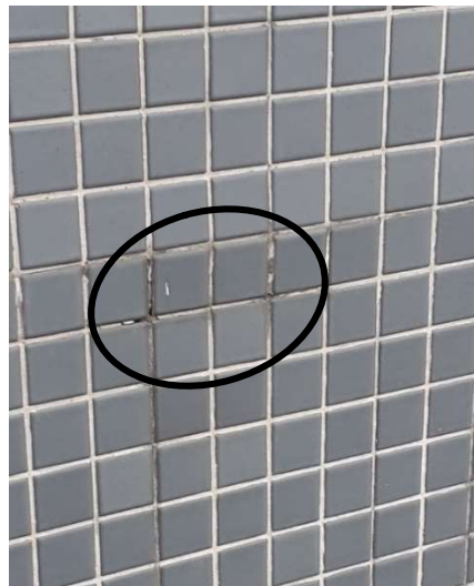
Figura 21 – Descolamento na fachada
