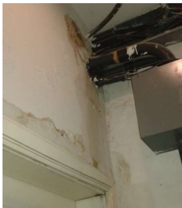
Figura 37 – Infiltração oriunda de água da laje no corredor
