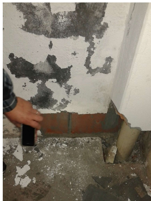
Figura 19 – Bolhas e pulverulência na torre dos reservatórios
