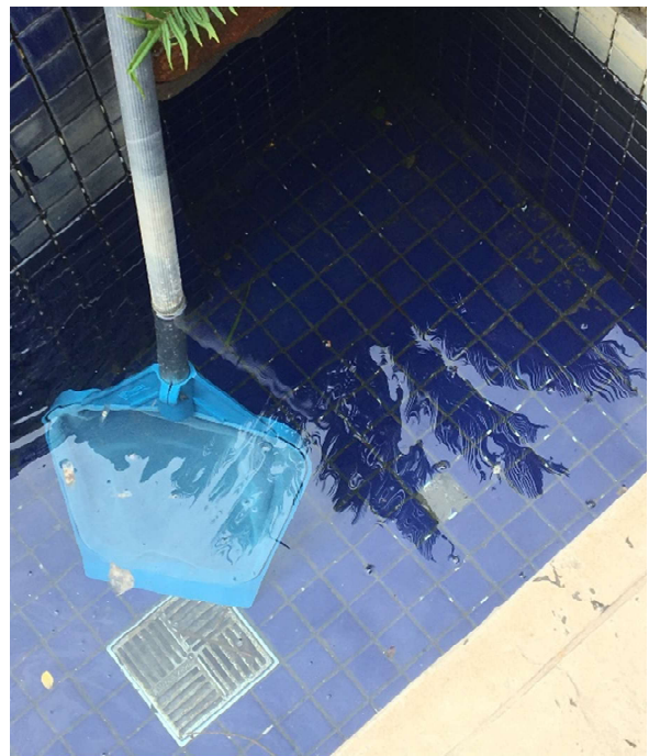
Figura 31 – Outro deslocamento na piscina
